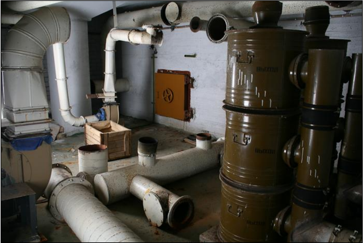
Foto 14. Kose varjendi ventilatsiooniruum. Foto Mihkel Leis ja Marek Astrik 2009
