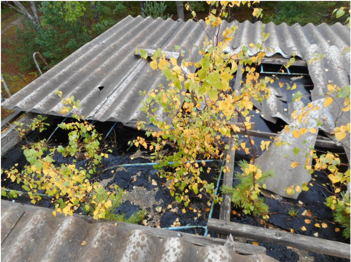
Foto 19. Komplekshoone katus (14.09.2017). Näha on plaatide alla painutatud röödupiirded.
