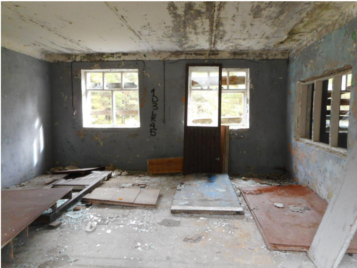
Foto 14. Komplekshoone I korruse suurema ruumi sisevaade (14.09.2017). Parempoolses vaheseinas on suur aken, nagu see oli nt kasarmute korrapidajaruumidel. Ruumi betoonpõrandal on suurem õlilaik – tõenäoliselt olid seal kunagi diiselagregaadid, kuid nende aluseid ega kinnitusjälgi pole (seinas on 3 kinnimüritud ava, mis võisid olla heitgaaside eemaldamiseks). Hiljem oli ruumil laudpõrand, millest on säilinud alusklotsid ja tõrvapapitükid.
