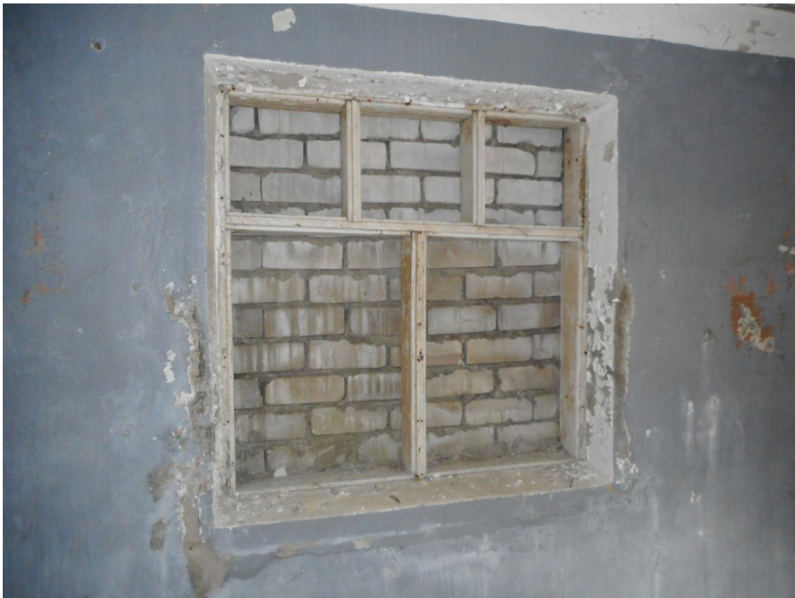
Foto 17. Komplekshoone II korruse suurema ruumi merepoolne väljastpoolt kinnimüüritud aken (14.09.2017).
