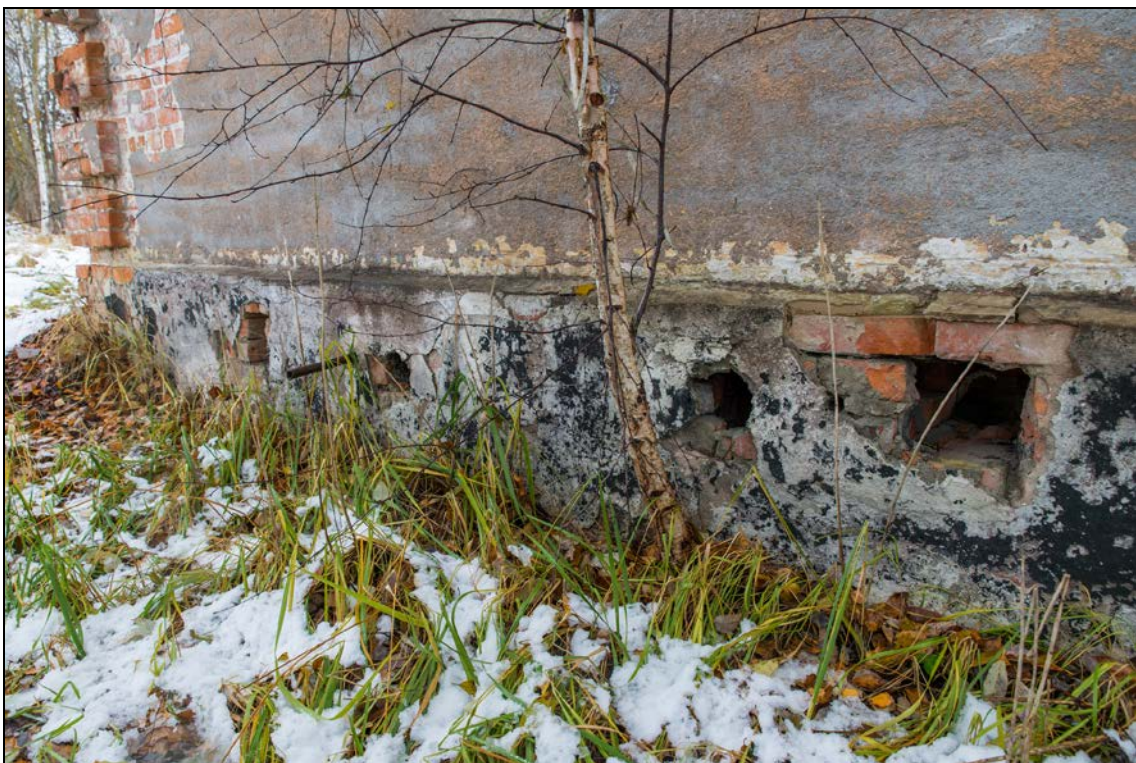
Foto 24 (503). Tartu Raadi lennuväli (aruanne 3, naftabaas). Hoone [43] alusmüüris on avaused torustike läbiviimiseks, Foto Mart Mõniste 26.10.2016
