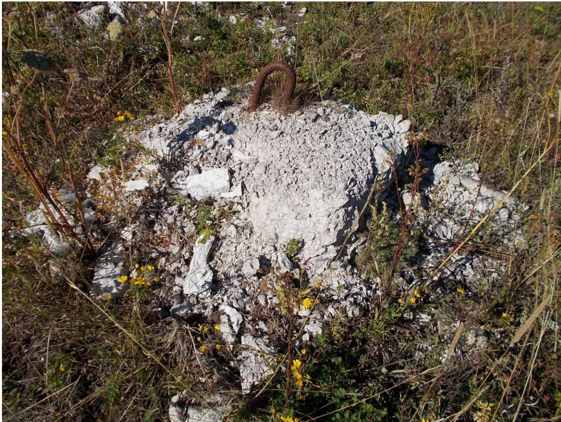
Foto 19. (58) Atla tehnilise vaatluse post. Tornü [9] tõmmitsa ülejäänud ankrute betoonalused on servadest ära pudisenud, kuid ilmselt saaks need pealevalamisega korda teha. Foto Jüri Pärn 19.08.2015.
