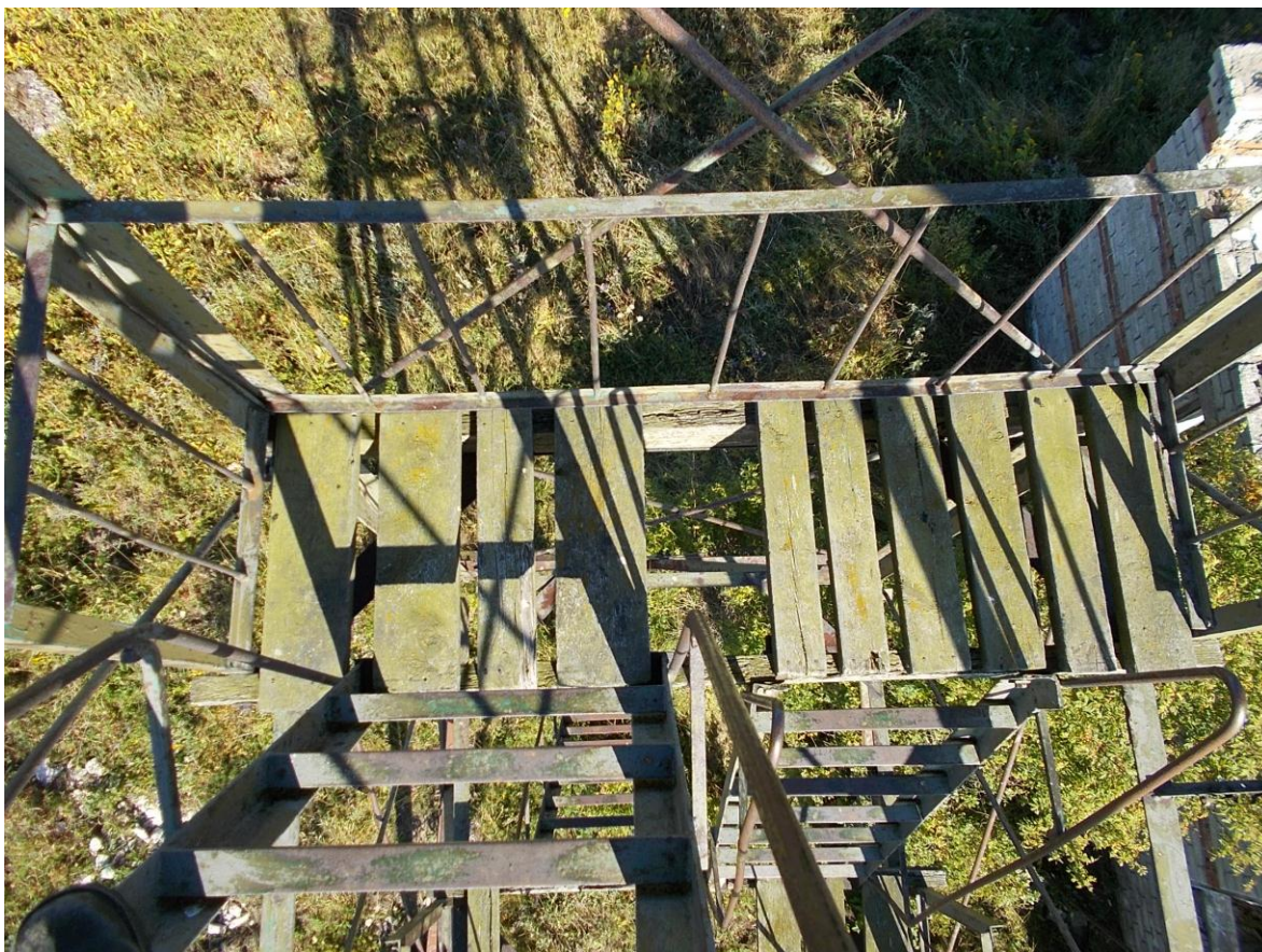
Foto 24. (222) Atla tehnilise vaatluse post. Torn [9]. Alt teine vaheplatvorm. See vajaks ainult keskele lisatala ning paari lauda ja „töotaks” veel aastakümneid. Foto Jüri Pärn 19.08.2015.
