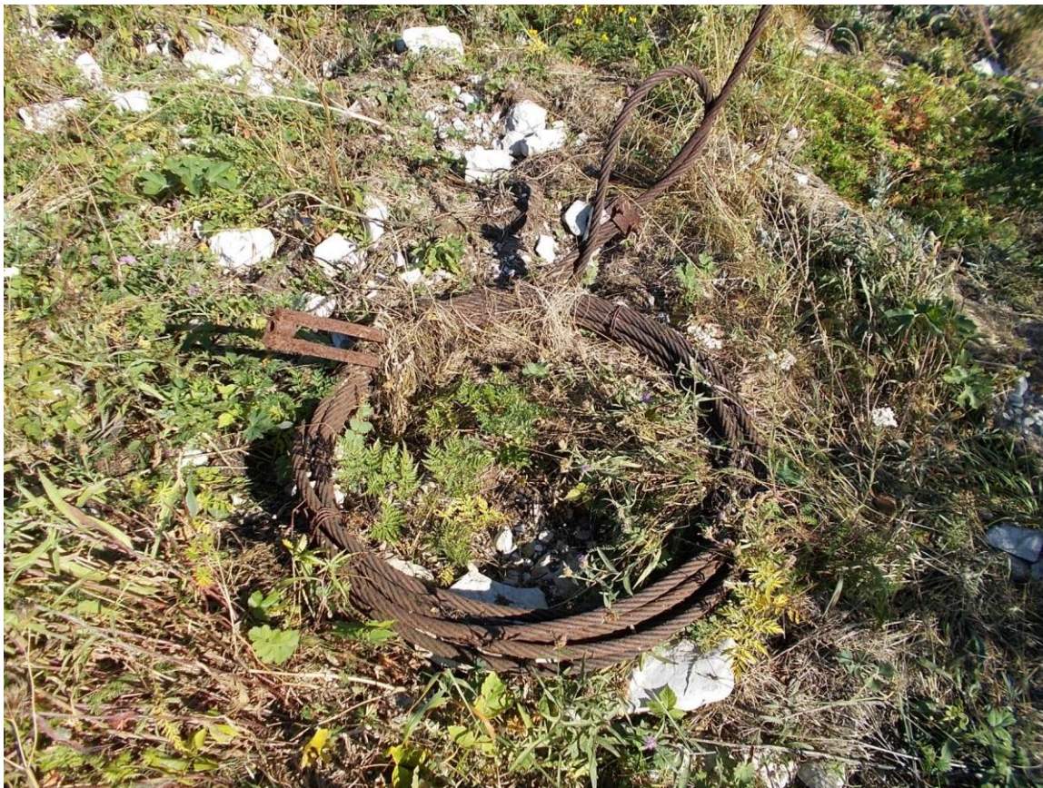
Foto 21. (69) Atla tehnilise vaatluse post. Torn [9] tõmmitsa tross varukeerdudega — u 2 cm jämedune ja paistab veel tugev olevat. Selliseid on kokku kolm. Tõmmitsate pingutid on ära varastatud, seetõttu ei täida tõmmitsad praegu oma funktsiooni. Foto Jüri Pärn 19.08.2015.
