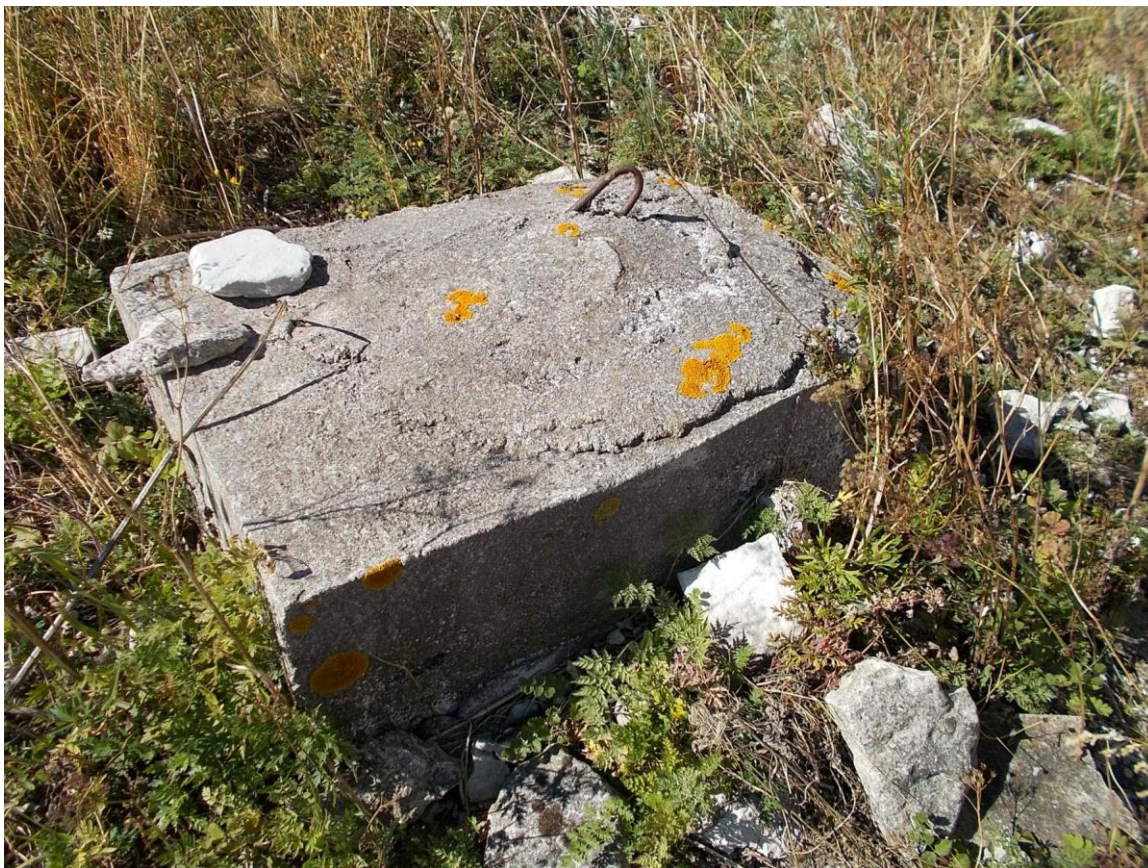
Foto 18. (37) Atla tehnilise vaatluse post. Torn [9] tõmmitsa merepoolne ankur operaatorihoone ukse ees — ainuke neljast, mille betoonalus on veel täiesti terve. Foto Jüri Pärn 19.08.2015.
