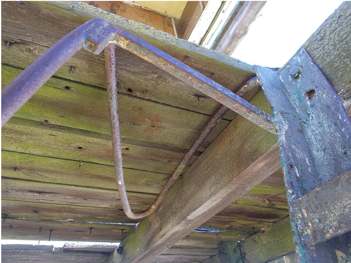
Foto 25. (229) Atla tehnilise vaatluse post. Torn [9]. Ülemise trepi käsipuud on painutatud põranda alla. Foto Jüri Pärn 19.08.2015.
