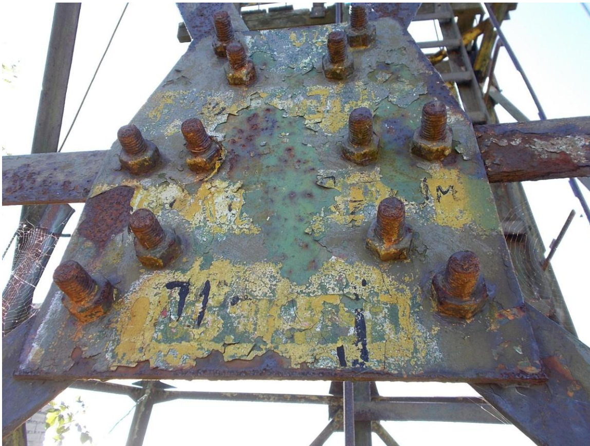
Foto 23. (89) Atla tehnilise vaatluse post. Torn [9]. Sellel ühendusplaadil on olnud torni number ja maandustakistuse andmed, kahjuks pole kirjad enam eriti loetavad. Maandustakistuse väärtused ja mõõtmiskuupäevad on veel säilinud ka vähemalt kolmes kohas torni nurkraudadel. Need võiks rekonstrueerimisel jätta üle värvimata. Foto Jüri Pärn 19.08.2015.
