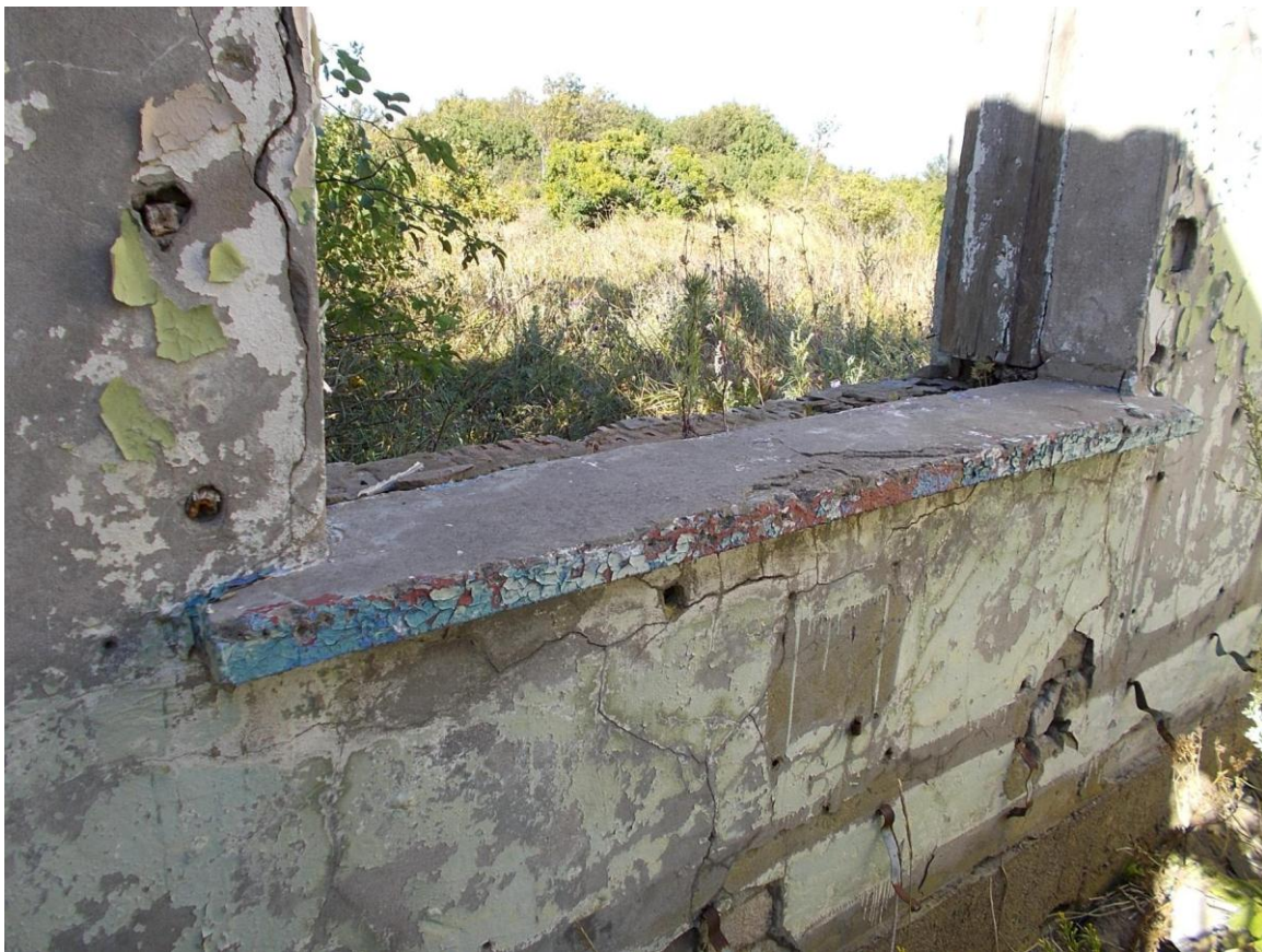
Foto 14. (204) Atla tehnilise vaatluse post. Operaatorihoone [7] aknalaud on betoonist valatud. Foto Jüri Pärn 19.08.2015.
