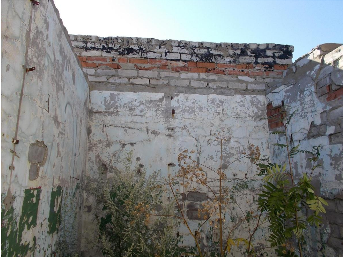
Foto 11. (185) Atla tehnilise vaatluse post. Operaatorihoone [7] sisevaade. Foto Jüri Pärn 19.08.2015.
