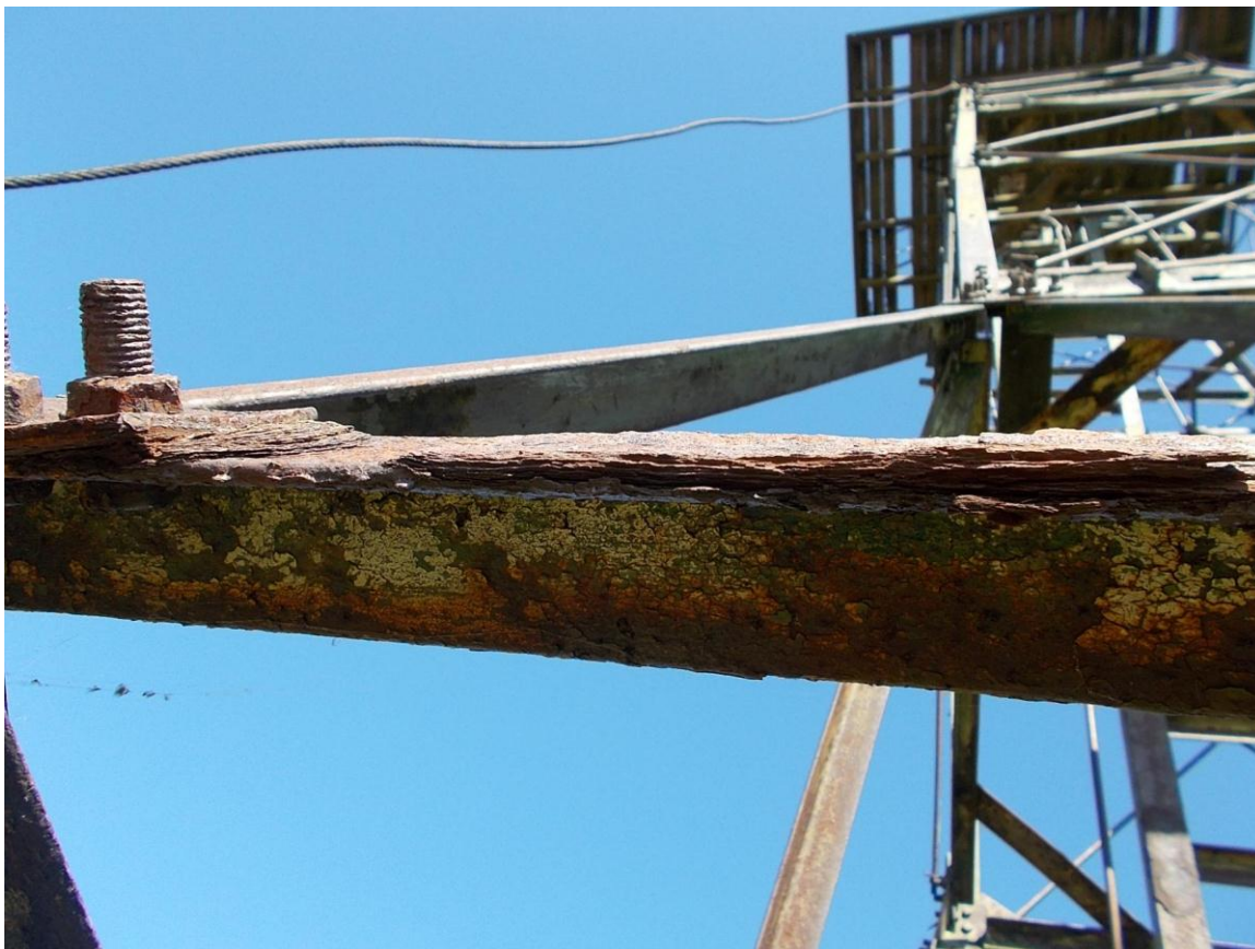
Foto 22. (74) Atla tehnilise vaatluse post. Torn [9]. Kohati on torn kaetud paksu roostekihistusega, kuid üllataval kombel pole see kuigi palju vähendanud metallkonstruktsiooni paksust. Foto Jüri Pärn 19.08.2015.
