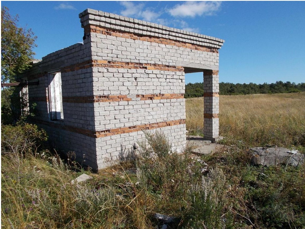
Foto 9. (56) Atla tehnilise vaatluse post. Operaatorihoone [7], paremal torni ankur, vasakul torni suunduvad radariantennide juhtmetorud. Foto Jüri Pärn 19.08.2015.
