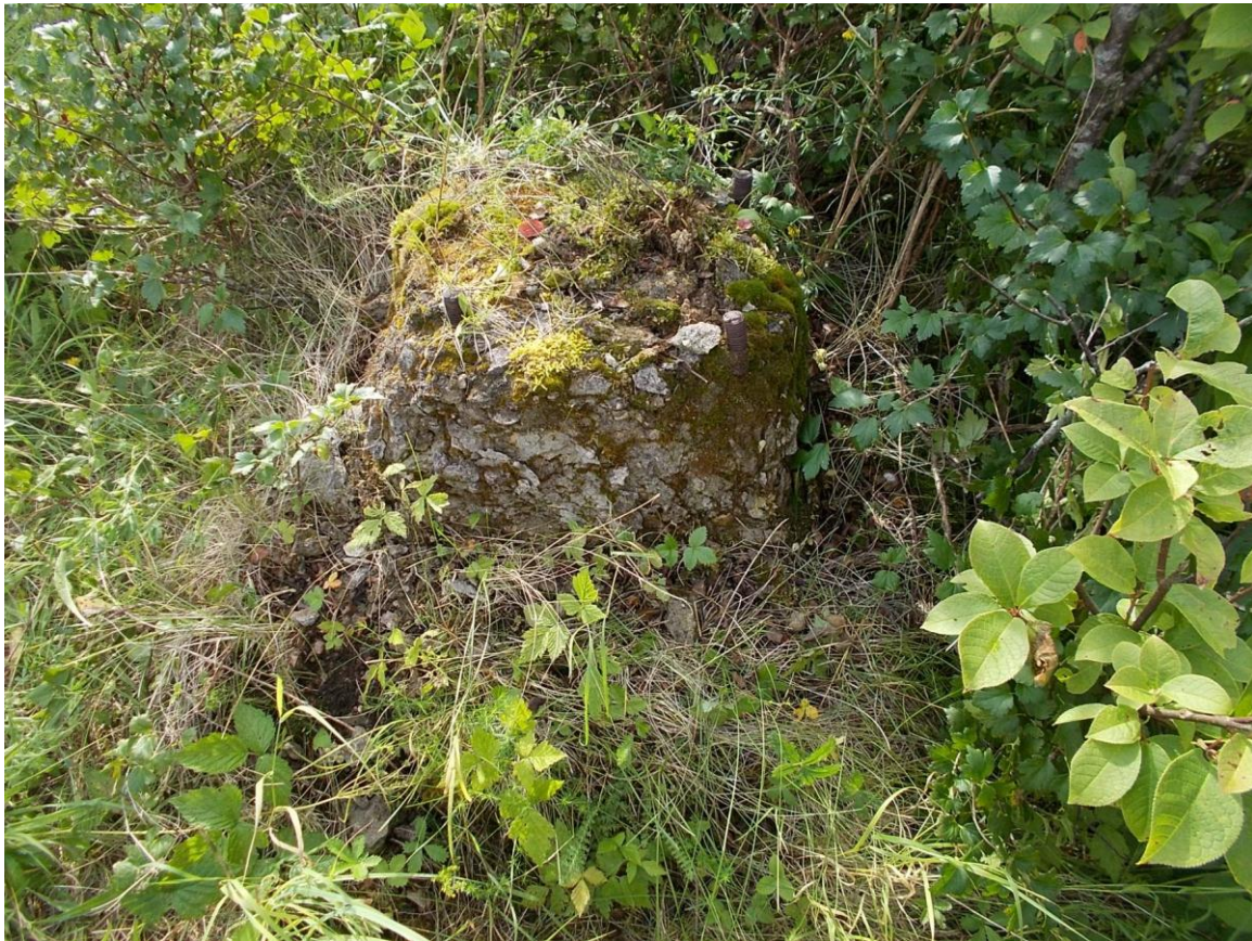
Foto 21. (74) Norrby tehnilise vaatluse post. Üks neljast torni [11] betoonalusest. Kõigi nende maapealsed osad on üsna lagununud. Foto Jüri Pärn 18.07.2015.
