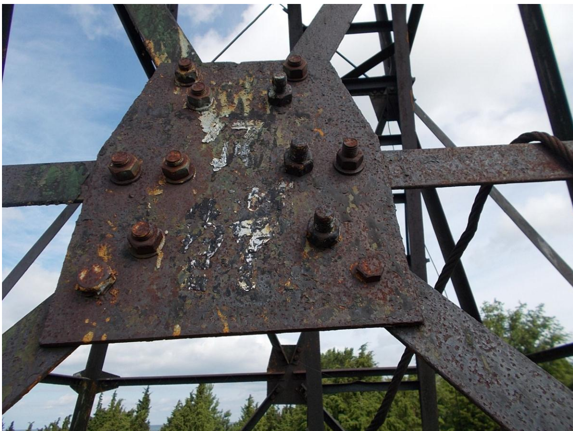
Foto 30. (117) Norrby tehnilise vaatluse post. Väike-Tjuka vaatlustorn [24]. Jalgade ühendusplaadil on kordoni ning torni number (vastavalt 17 ja 27). Ühel jalal on raskesti loetavad maandustakistuse mõõtmisandmed. Foto Jüri Pärn 18.07.2015.
