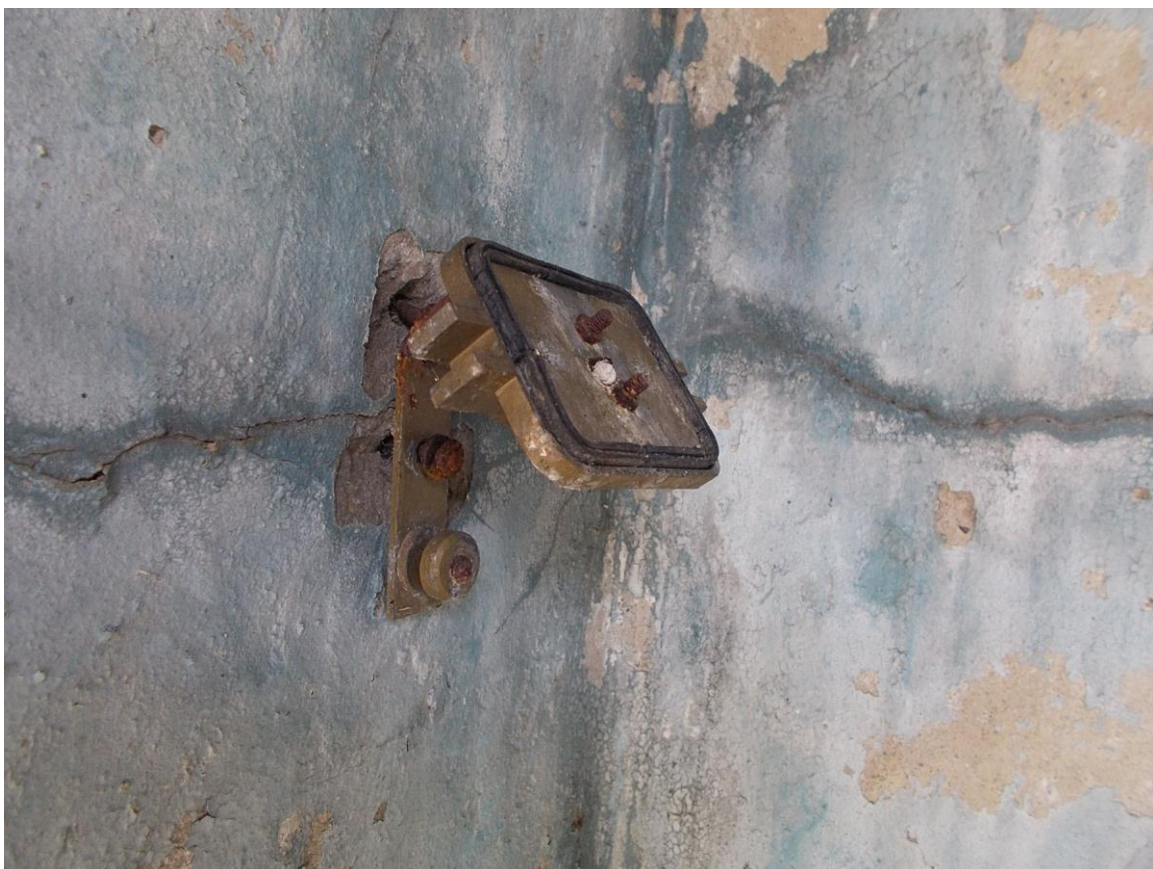
Foto 40. (138) Norrby tehnilise vaatluse post. Hoone [25]. Telefonipistiku kronstein lavatsi kohal. Foto Jüri Pärn 18.07.2015.
