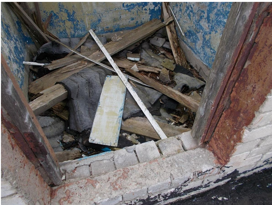
Foto 6. (12) Norrby tehnilise vaatluse post. Hoone [6], II korruse sisevaade (tõrvapappkatuse rusud on põrandal). Foto Jüri Pärn 18.07.2015.
