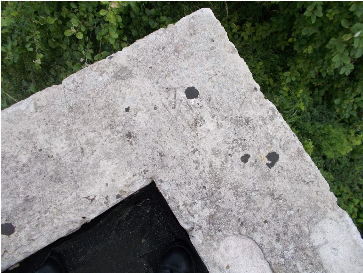
Foto 9. (31) Norrby tehnilise vaatluse post. Hoone [6] I korruse katuse ääriolele on kraabitud südamesümbol raskestiloetava tekstiga (südamedaami nimi?). Foto Jüri Pärn 18.07.2015.
