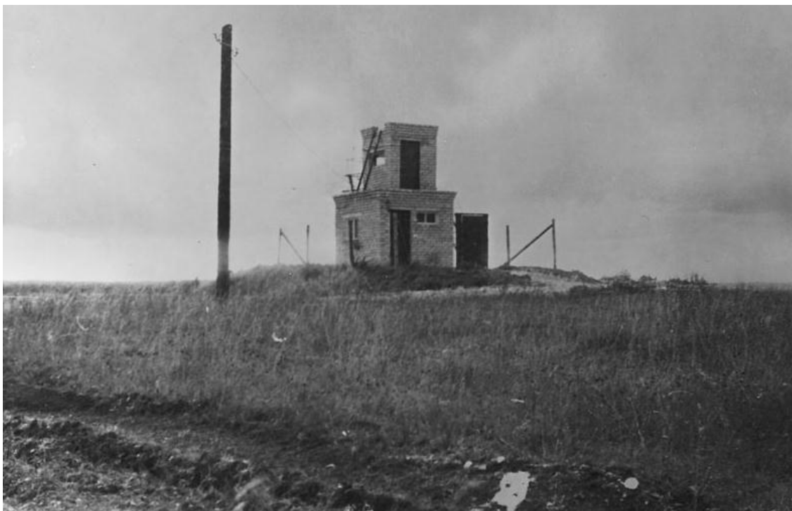
Foto 45. (norbyRLP.jpg) Norrby raadiolokatsiooniposti hoone [4]. Vaade loodest, u 1985?.a. Hoonest paremal paistab jalgvärv. I korruse põhjapoolne aken on veel kinni müürimata. Foto allikas http://vormsi-17.narod.ru/andrew_ph.html , Фотоальбом Андрея (teenistusaeg 1983–1985), vaadatud 27.09.2016.
