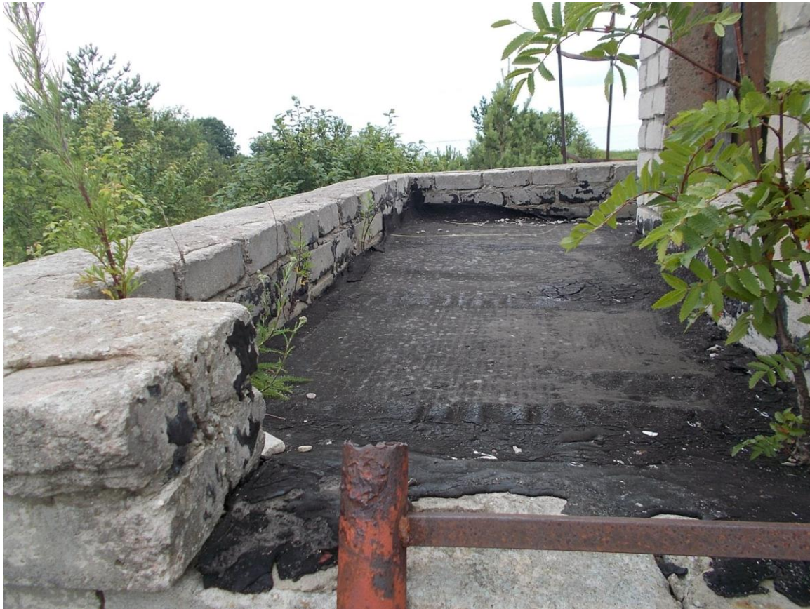
Foto 5. (11) Norrby tehnilise vaatluse post. Hoone [6] I korruse katus tundub vettpidav. Foto Jüri Pärn 18.07.2015.
