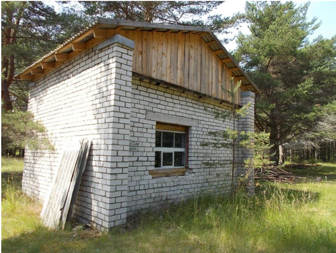
Foto 63. (322) Hullo piirivalvekordon. Puurkaevuga pumbamaja [50]. Katus renoveeritud. Foto Jüri Pärn 15.07.2015.
