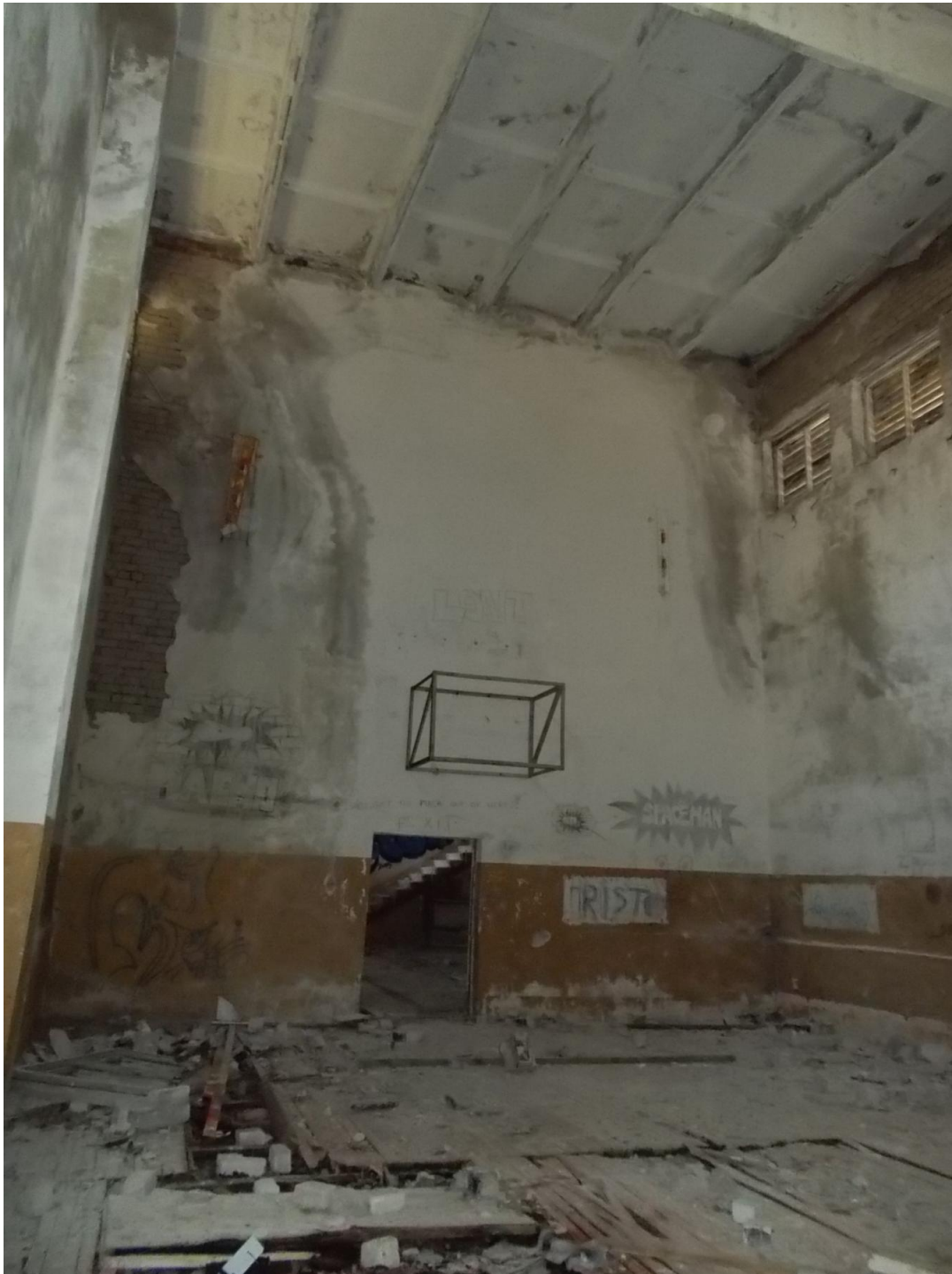
Foto 10. (676) Hullo piirivalvekordon. Hoone [1] korvpallisaal, vaade klubiruumi poole (uksest paistab trepp). Foto Jüri Pärn 15.07.2015.
