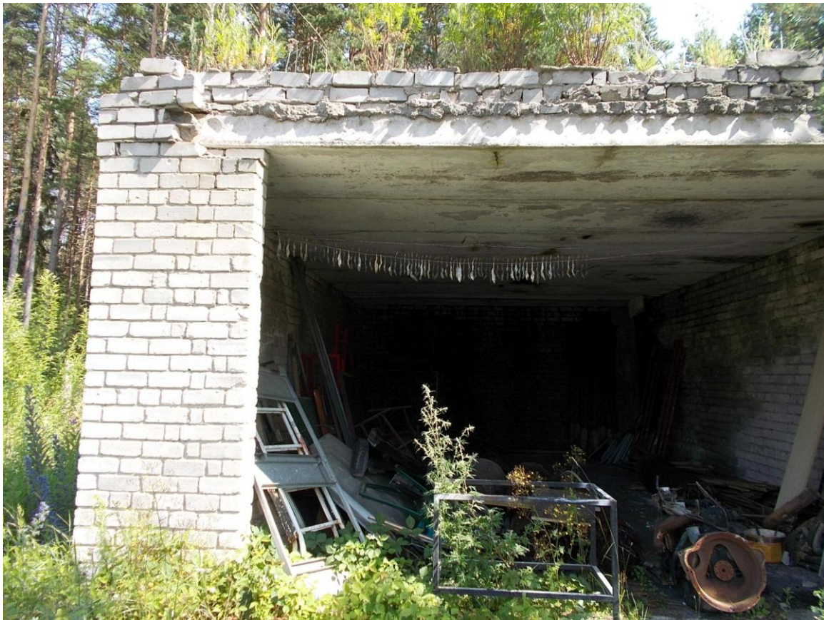
Foto 40. (194) Hullo piirivalvekordon. Majandushoone [12] (katlakütteladu/laut/diisliruum/akuruum?). Katuseäärt toestanud I-tala on välja kistud (vrd foto 69). Foto Jüri Pärn 15.07.2015.
