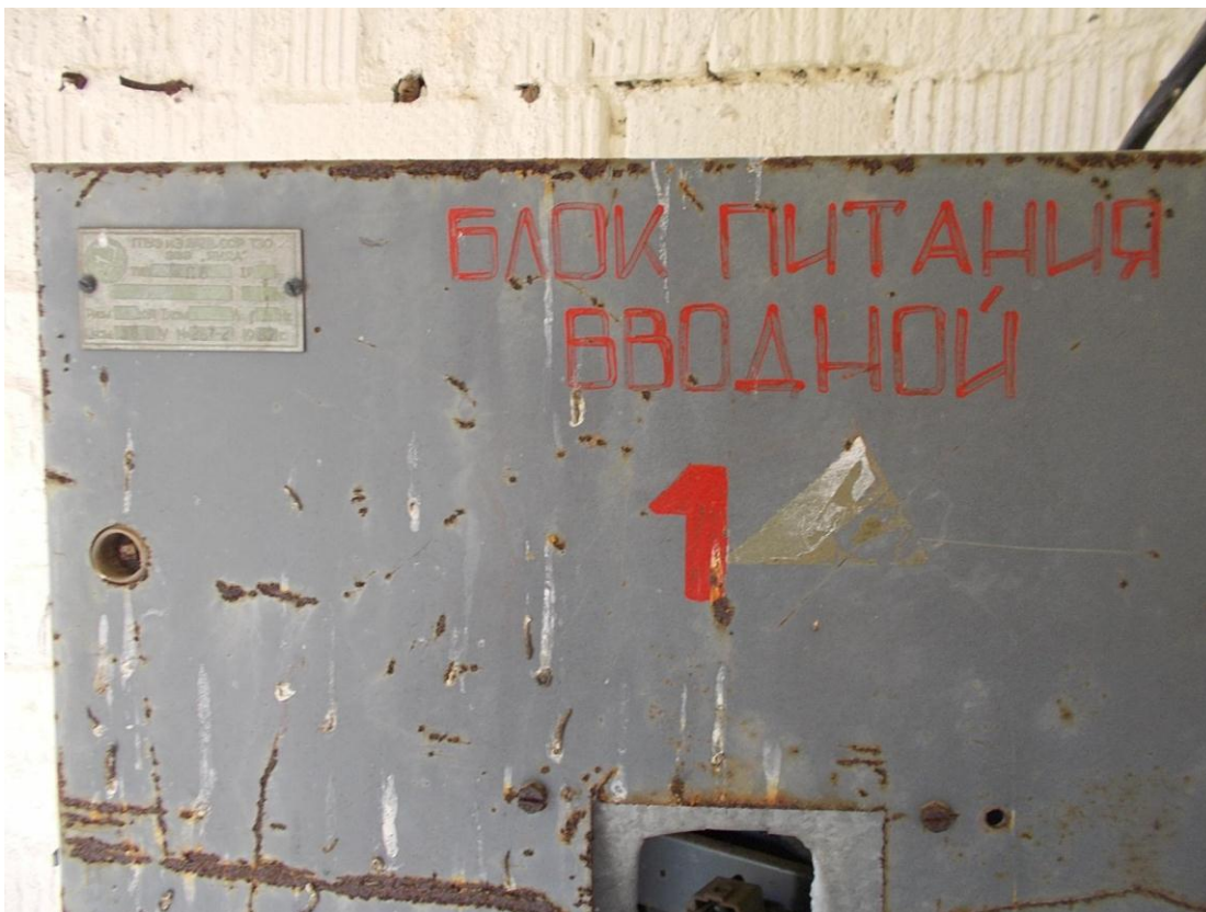
Foto 50. (495) Hullo piirivalvekordon. Kanalisatsiooni pumbamaja [20]. Takistusriba (lõuna-) poolne ruum: sisendipoole toitebloki kilp, valmistatud Lätis 1987.a. Foto Jüri Pärn 15.07.2015.
