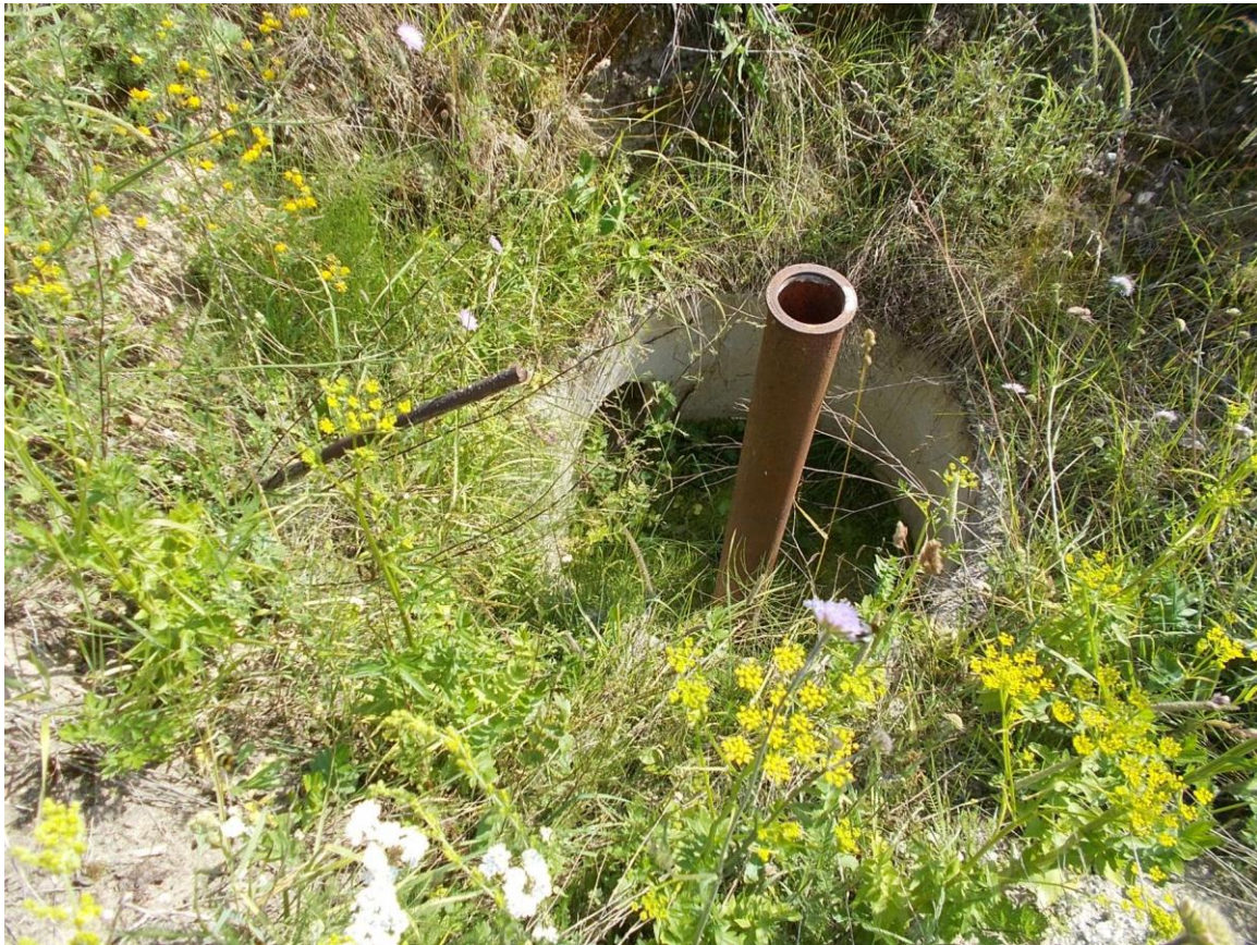
Foto 47. (532) Hullo piirivalvekordon. Lahtikaevatud ümbrusega kommunikatsioonikaev [18], mille keskel on u 10 cm läbimõõduga terastoru. Foto Jüri Pärn 15.07.2015.
