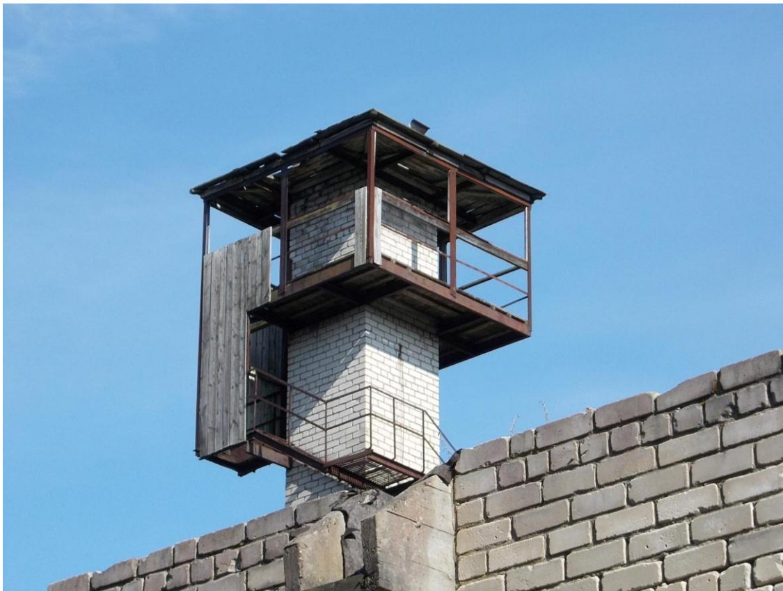
Foto 29. (1159) Hullo piirivalvekordon. Hoone [1] korsten-torn. Vaade torniruumile elamu [6] poolsest küljest. Algselt oli tõenäoliselt kogu piirdekonstruktsioon laudvoodriga kaetud, vrd fotod 73 ja 5. Foto Jüri Pärn 15.07.2015.
