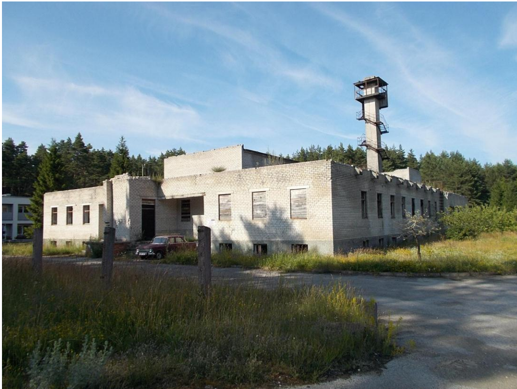
Foto 1. (1201) Hullo piirivalvekordon. Kordoni peahoone [1] (komplekshoone — staap/kasarmu/söökla/klubi/spordisaal/garaaž/laod/katlamaja/vaatlustorn/raadiomastialus ühe hoonena). Vaade edelast, sissesõiduvärava asukohast. Foto Jüri Pärn 15.07.2015.
