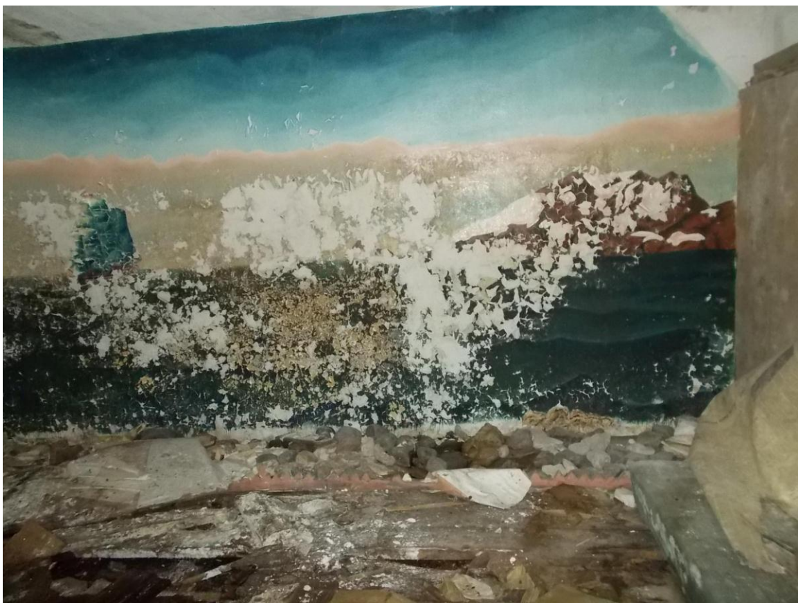
Foto 14. (771) Hullo piirivalvekordon. Hoone [1] soklikorrusel ühe akendeta ruumi seinal on meremaal. Foto Jüri Pärn 15.07.2015.
