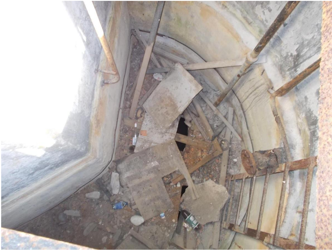
Foto 51. (498) Hullo piirivalvekordon. Kanalisatsiooni pumbamaja [20]. Takistusriba (lõuna-) poolne ruum: alla viib metallredel, põhjas on hädapäraselt kinnikaetud reservuaariava. Foto Jüri Pärn 15.07.2015.
