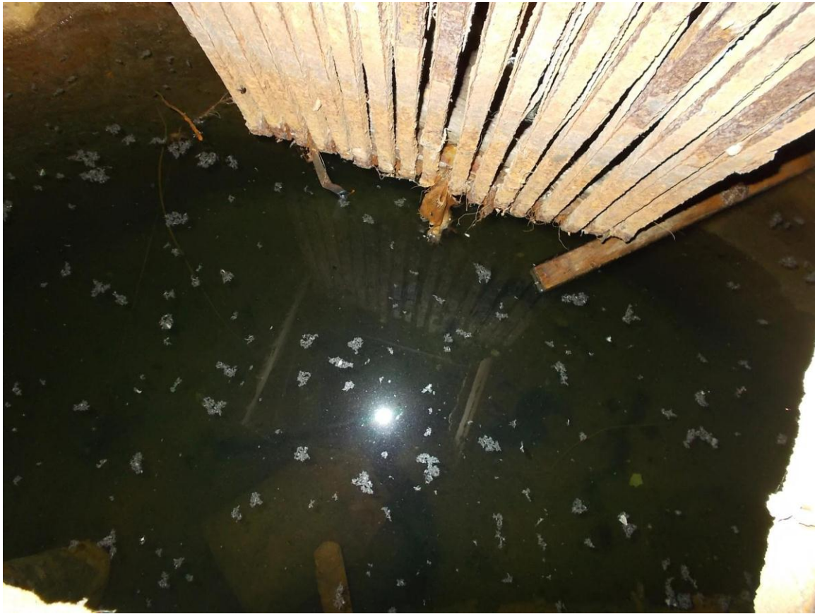
Foto 53. (512) Hullo piirivalvekordon. Kanalisatsiooni pumbamaja [20]. Hoone [1] (põhja-) poolne ruum, vaade luugiavast alla: paistab vesi ning mingi roostes agregaat (veepuhastusseadme osa?). Foto Jüri Pärn 15.07.2015.
