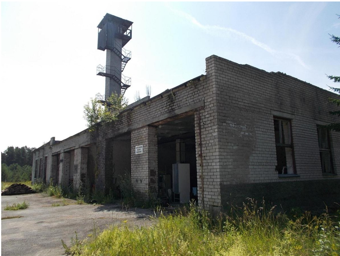
Foto 4. (153) Hullo piirivalvekordon. Hoone [1] vaade kirdest (ees garaažiboksid, tagapool katlaruum telliskorstnaga). Foto Jüri Pärn 15.07.2015.
