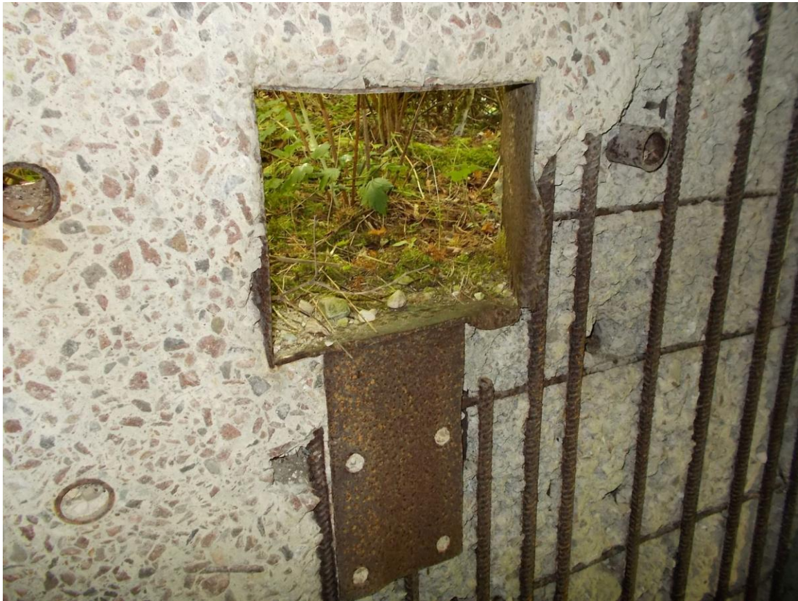
Foto 28. (393) Borrby tehnilise vaatluse post. Läänepoolne dott [24], sisevaade. Betoon on armatuuri küljest lahti löönud. Sellel dotil uks ja leng puuduvad. Foto Jüri Pärn 16.07.2015.
