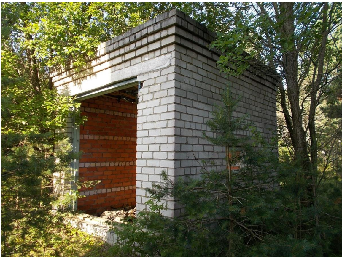
Foto 19. (172) Borrby tehnilise vaatluse post. Kütuse- ja määrdeainehoidla [17], vaade kirdest. Mere pool on väike aken. Katus on mädanenud ja osalt sisse vajunud, aga muidu on hoone väga heas seisukorras. Foto Jüri Pärn 16.07.2015.
