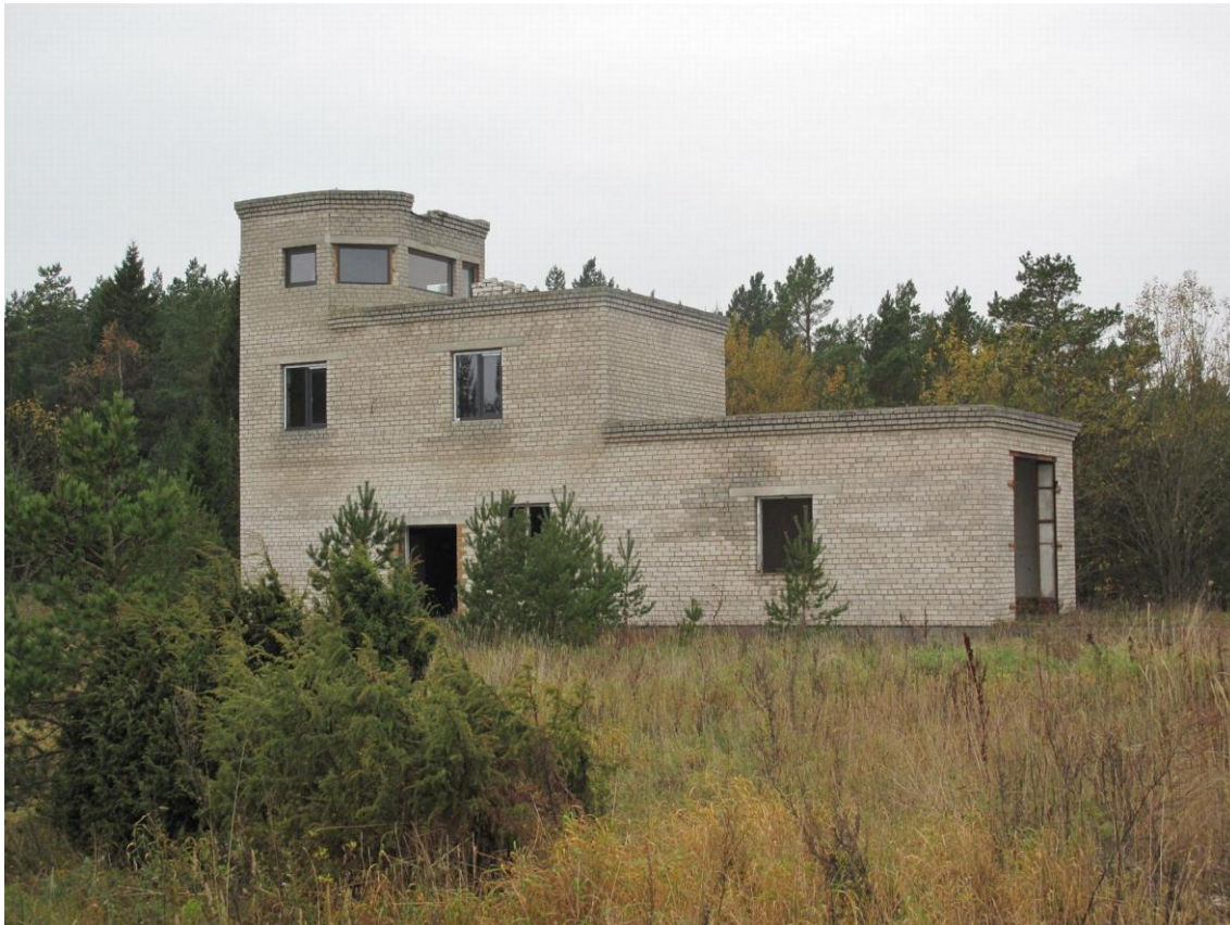
Foto 34. (Greenbelt_VO_2_11_Piirivalvehoone_Rälby_küla.jpg) Borrby tehnilise vaatluse post 2010.a oktoobris. Komplekshoonel [x] puuduvad rõdupiirded, metalltrepp, ülemine karniis on veidi lagunenu. Torniosa aknad on juba asendatud pakettakendega. Foto: Helena Semm või Priit Tomson 20.10.2010.
