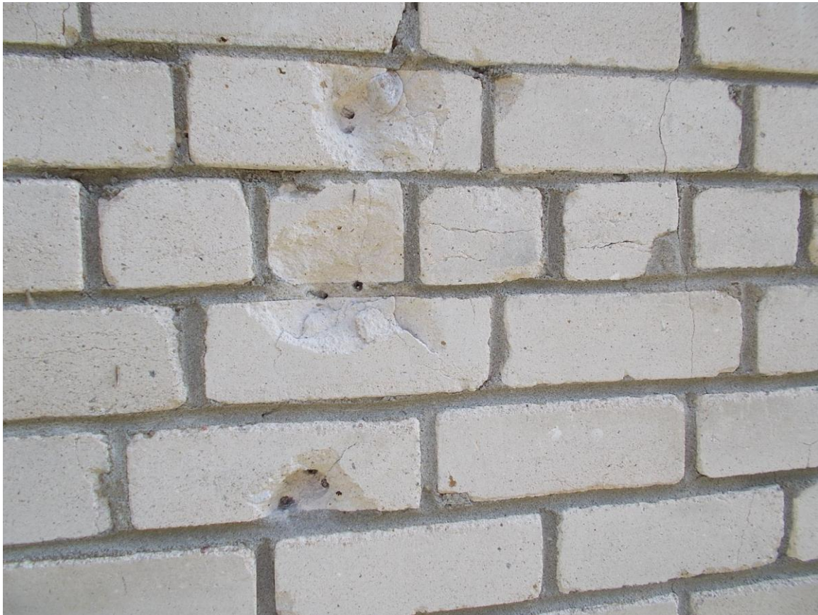
Foto 12. (197) Borrby tehnilise vaatluse post. Komplekshoone [16] lõunaseinal on paarkümmend kuuliauku (kuulid sees). Foto Jüri Pärn 16.07.2015.
