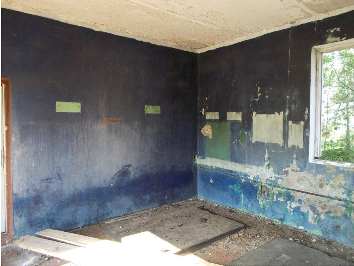
Foto 14. (228) Borrby tehnilise vaatluse post. Komplekshoone [16], diisliruumi sisevaade. Ruumis on 3 betoon-diislialust. Seinal on kiri „Vastutav Bepalov” ja näha on seinale kinnitatud seadmete kontuurid. Foto Jüri Pärn 16.07.2015.
