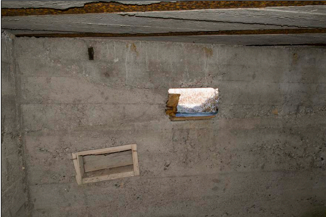
Foto 9 (260). Kõnnu (Torma) radarijaam. Dott [4]. Dbetoonivalu on suhteliselt korralik, aga seinavard on kohati väga viltused. Foto Mart Mõniste 30.03.2017.
