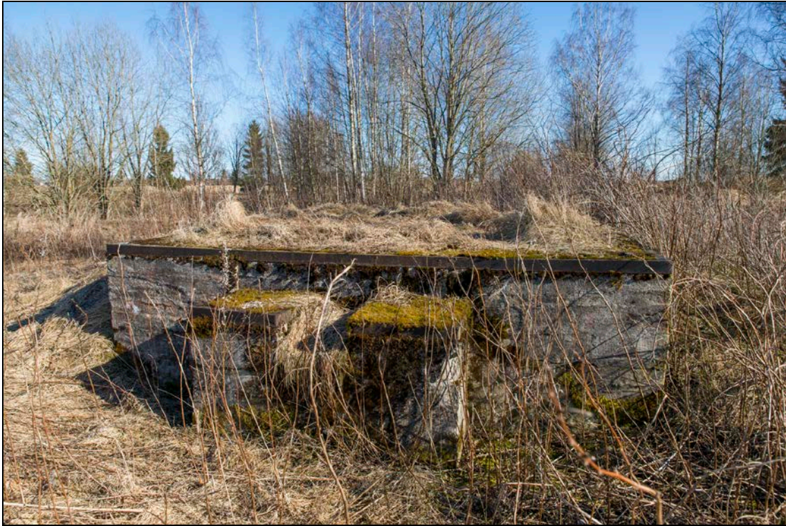
Foto 13 (270). Kõnnu (Torma) radarijaam. Estakaad [5]. Foto Mart Mõniste 30.03.2017.
