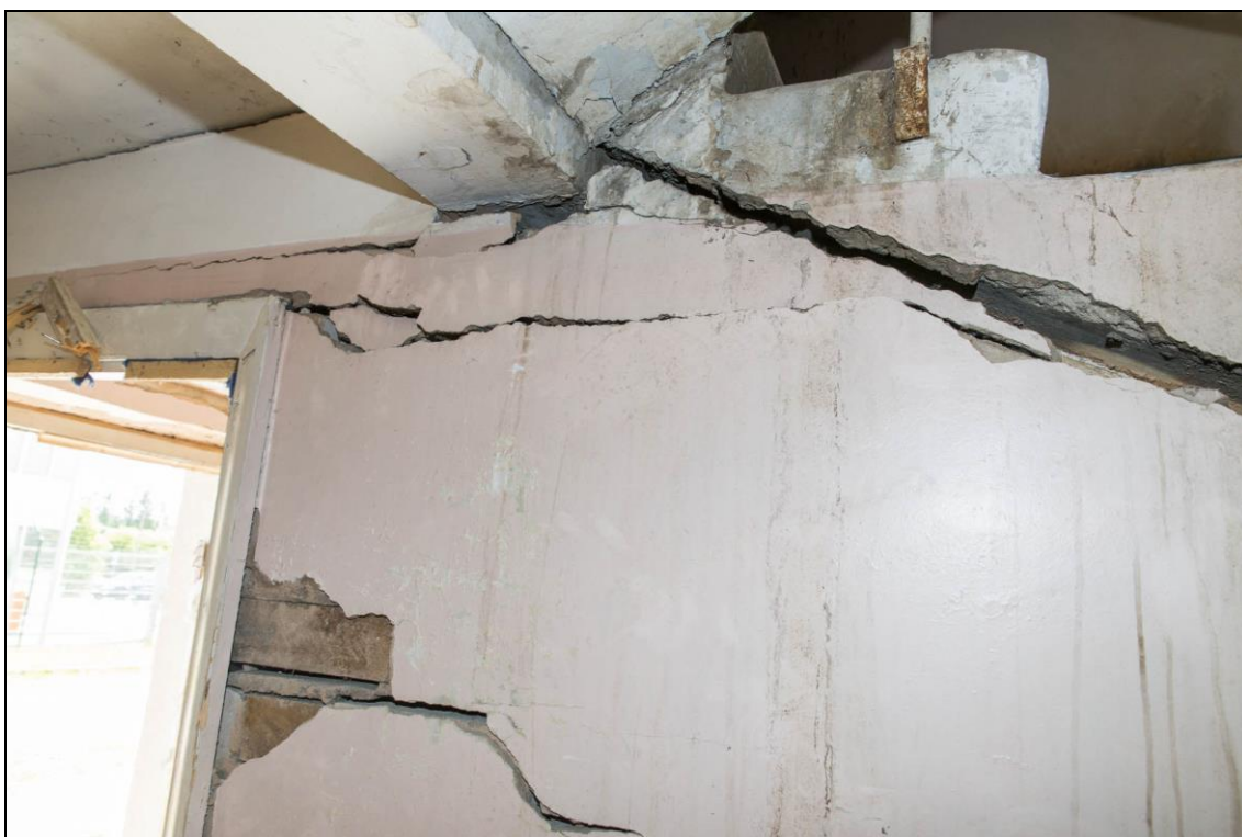
Foto 54 (159). Aia 38 laohoone Jõgeval. Laokorpus [1]. Esimese korruse trepikoja seinas on vajumisest tekkinud praod. Foto Mart Mõniste 7.06.2018.
