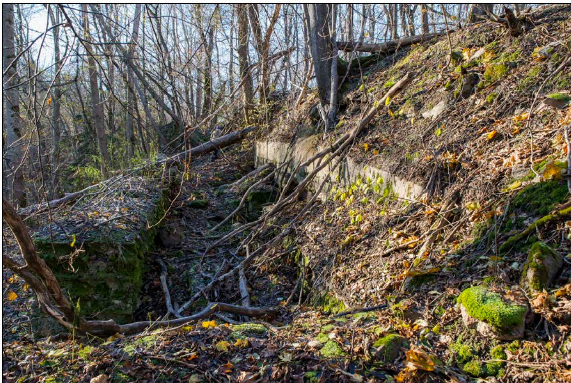
Foto 54 (402). Meriküla 10-tolline patareid. Laskemoonahoidla [6]. Sissepääsu ees oleva tamburi lagi on sisse varisenud. Foto Mart Mõniste 2.11.2017.
