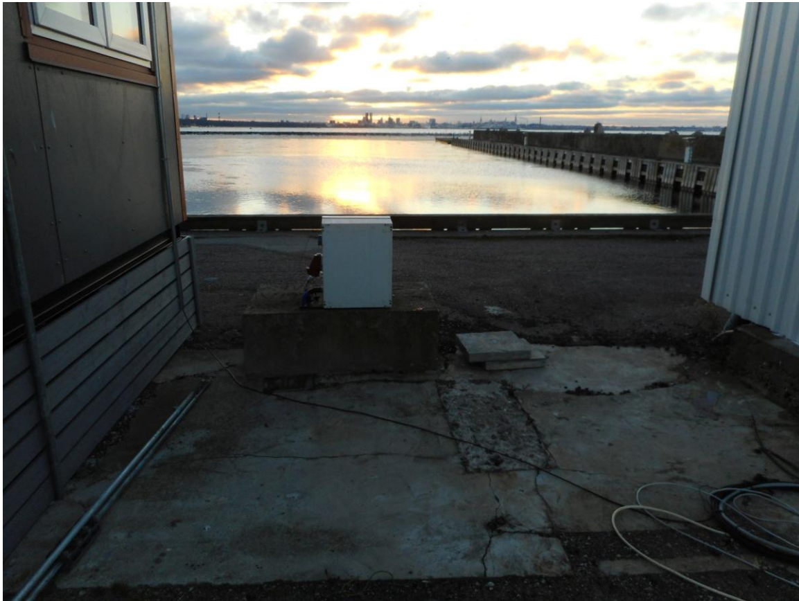
Foto 7. (28) Pirita tehnilise vaatluse post. Operaatorihoone asukoht ja selle betoonalused [4]. Vaade kirdest. Keskel ja vasakul hoone [3] serva all on maatasa raiutud alused, neljas peaks olema veel hoone [3] all. Foto Jüri Pärn 6.12.2016.
