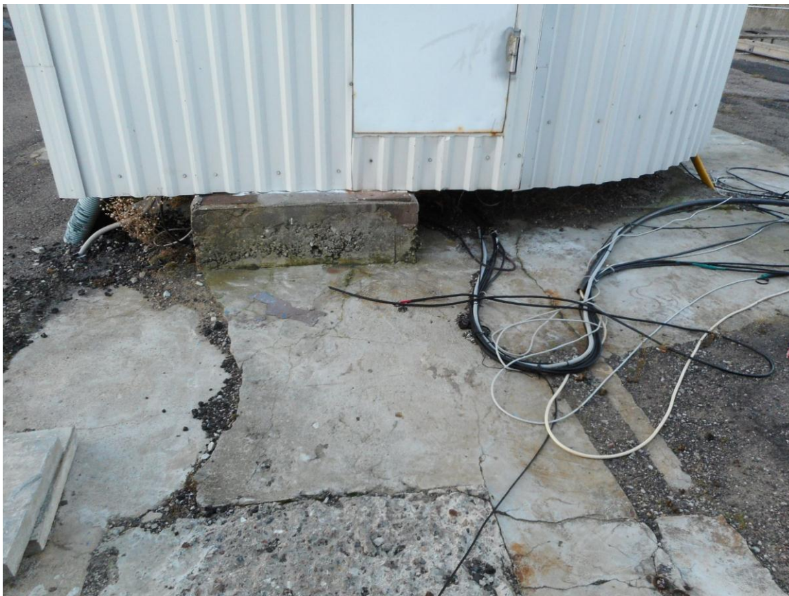
Foto 6. (24) Pirita tehnilise vaatluse post. Operaatorihoone asukoht ja betoonalused [4]. Neljast? kõrvuti asunud alusest on säilinud üks, teised on maatasa raiutud. U 2,5 m laiune betooniriba näitab hoone asukohta. Foto Jüri Pärn 6.12.2016.
