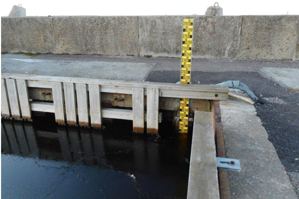
Foto 26. (71) Piritas tehnilise vaatluse post. Põikikail loodeserval on üle 1 m kõrgune betoonmüür [7], mille tagant Uazik merelt auto moodi välja ei paista. Veemõõdulati kohaselt peaks veetase olema +100 cm. Foto Jüri Pärn 6.12.2016.
