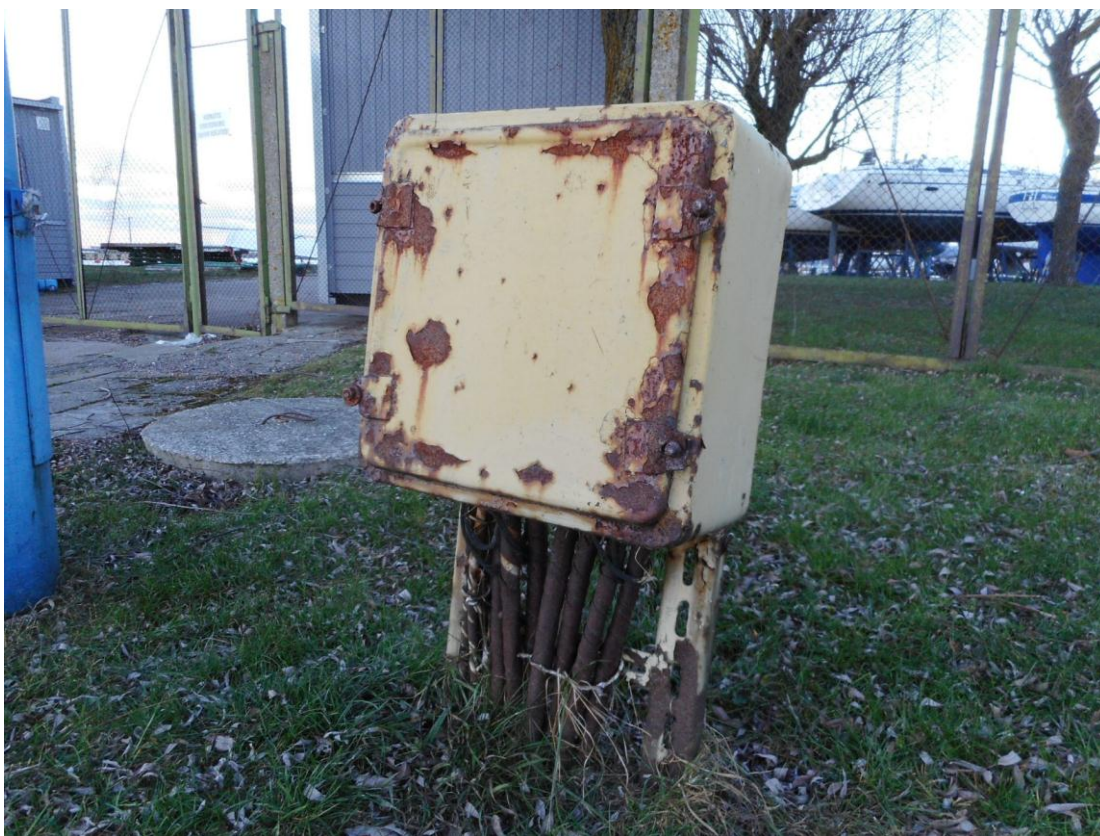
Foto 2. (6) Pirita tehnilise vaatluse post. Vana elektrikaablite ühenduskapp [1]. Siit said ka piirivalvurid oma voolu. Foto Jüri Pärn 6.12.2016.
