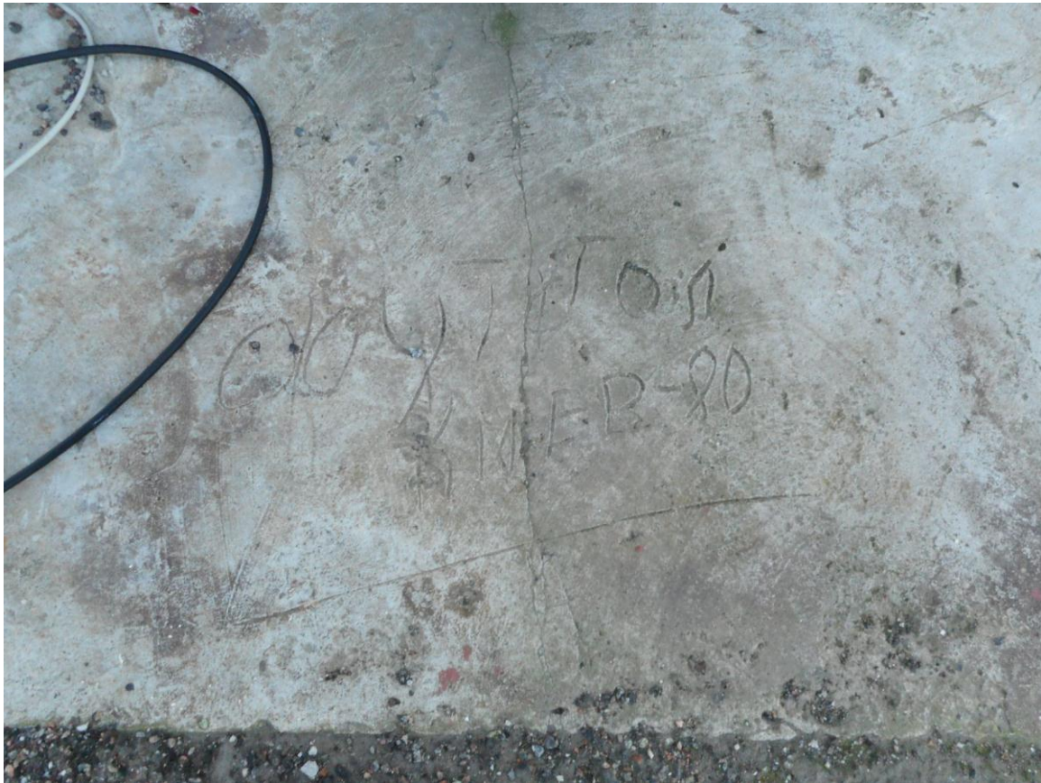
Foto 22. (30) Pirita tehnilise vaatluse post. Kirjad vundamendi betoonäärisel [6] (1979–80). Võivad kuuluda sõjaväelastest ehitajaile või kordoni enda piirivalvureile. Ilmselt on see ääris valatud mõnda aega peale torni valmimist ja mitte tuletorniehitajate poolt. Foto Jüri Pärn 6.12.2016.
