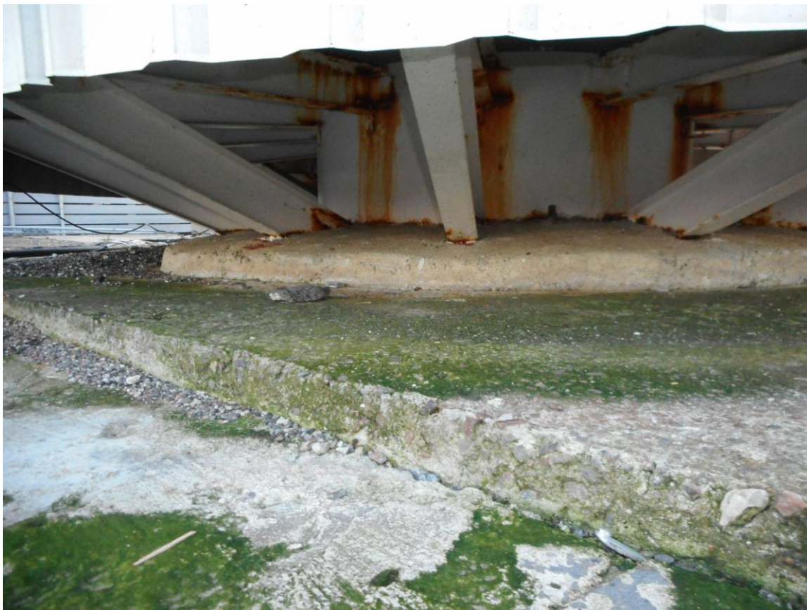
Foto 13. (43) Pirita tehnilise vaatluse post. Torni [5] vundamendi vaade põhjast. Ümmargune (silindriline) u 2 m läbimõõduga vundamendiosa on kvaliteetsemast betoonist, seda ümbritseb jämedama tekstuuriga nelinurkne osa (betoonkast?). Foto Jüri Pärn 6.12.2016.
