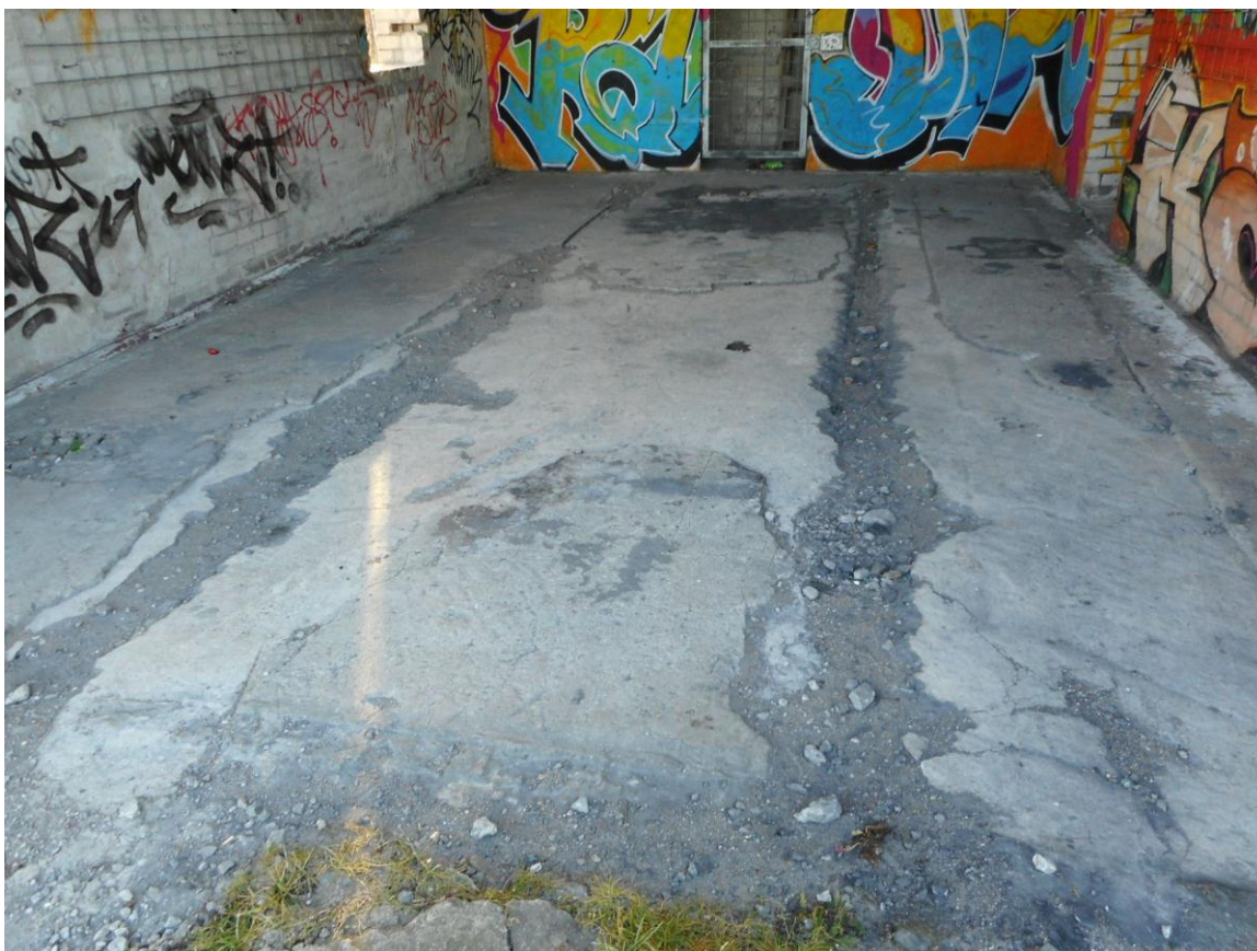
Foto 6. (75) Paljassaare tehnilise vaatluse post. Hoone [4] prožektoriruum. Relsid on välja kistud, seinad ära pläkerdatud. Taga on lukustatud uksega väike ruum (endine akuruum?), kus hoitakse reedeid jm remonditarbeid. Foto Jüri Pärn 16.10.2016.
