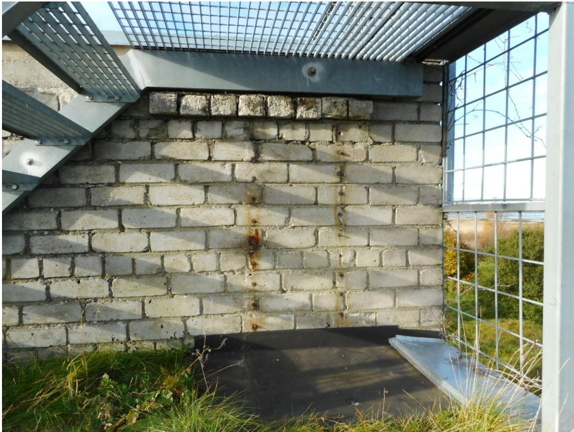
Foto 23. (226) Paljassaare tehnilise vaatluse post. Hoone [4] algse välistrepi asukoht. Seinas on kaks rida pliipulkadest naelatüubleid. Foto Jüri Pärn 16.10.2016.
