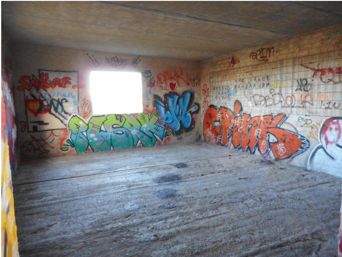
Foto 13. (129) Paljassaare tehnilise vaatluse post. Hoone [4] II korruse operaatoriruumi sisevaade. Järjekordne seinavõre, järjekordsed mäkerdised. Aparatuuri jälgi seintel ei hakanud silma. Arvatavasti on siin olnud puitpõrand. Foto Jüri Pärn 16.10.2016.
