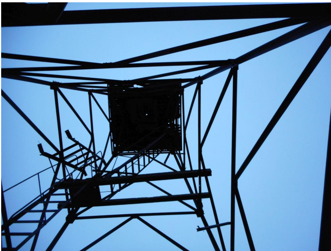
Foto 60. (950) Neeme tehnilise vaatluse post. Torn [26] altvaade. Ülemine trepp on allapoole kukkunud, kuna tema tugipruss on mädanenud. Foto Jüri Pärn 8.12.2016.
