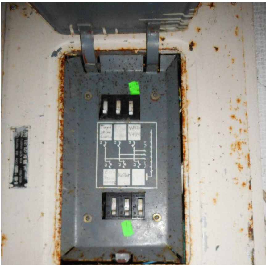
Foto 40. (603) Neeme tehnilise vaatluse post. Soojaku [19] elektrikilp. Foto Jüri Pärn 8.12.2016.
