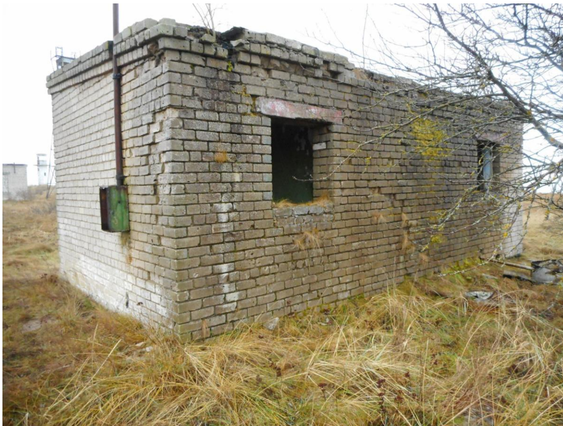
Foto 29. (386) Neeme tehnilise vaatluse post. Diislihoone [14]. Vaade kagust. Elektrilülituskilbil on säilinud number „3”. Seinal on kirjad „ДМБ 76?” ja „77”. Ainult idasein on perioodilise vihmavee pealevoolu tõttu kahjustunud, kuid see on parandatav (muidugi tuleks lagunemise peatamiseks ka räästast veidi pikendada). Foto Jüri Pärn 8.12.2016.
