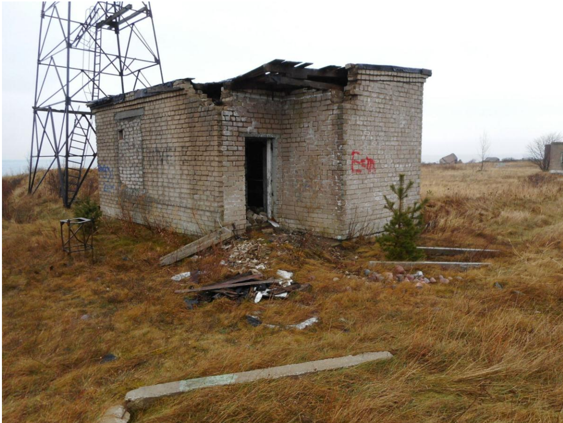
Foto 45. (476) Neeme tehnilise vaatluse post. Operaatorihoone [23]. Vaade edelast. Nurga tugipost on lammutatud ja kivid esikupõrandale loobitud. Foto Jüri Pärn 8.12.2016.
