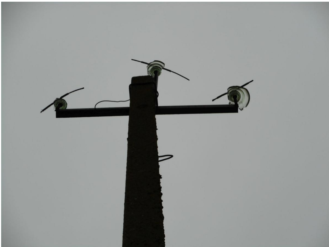
Foto 4. (166) Neeme tehnilise vaatluse post. Objekti endine keskpingeliin. Enamus isolaatoreid on purustatud. Foto Jüri Pärn 8.12.2016.
