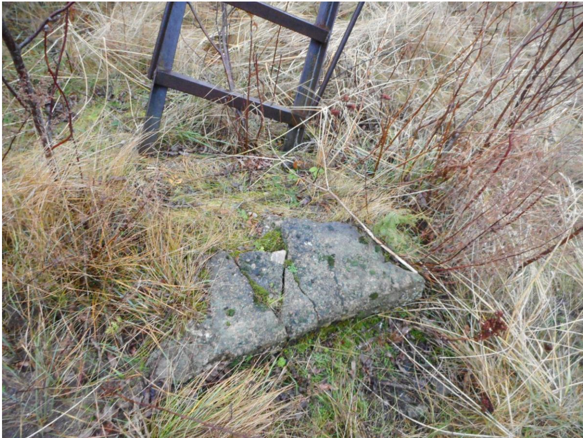
Foto 55. (490) Neeme tehnilise vaatluse post. Torni [26] alumise trepi ots on aluse küljest lahti murdunud. Foto Jüri Pärn 8.12.2016.
