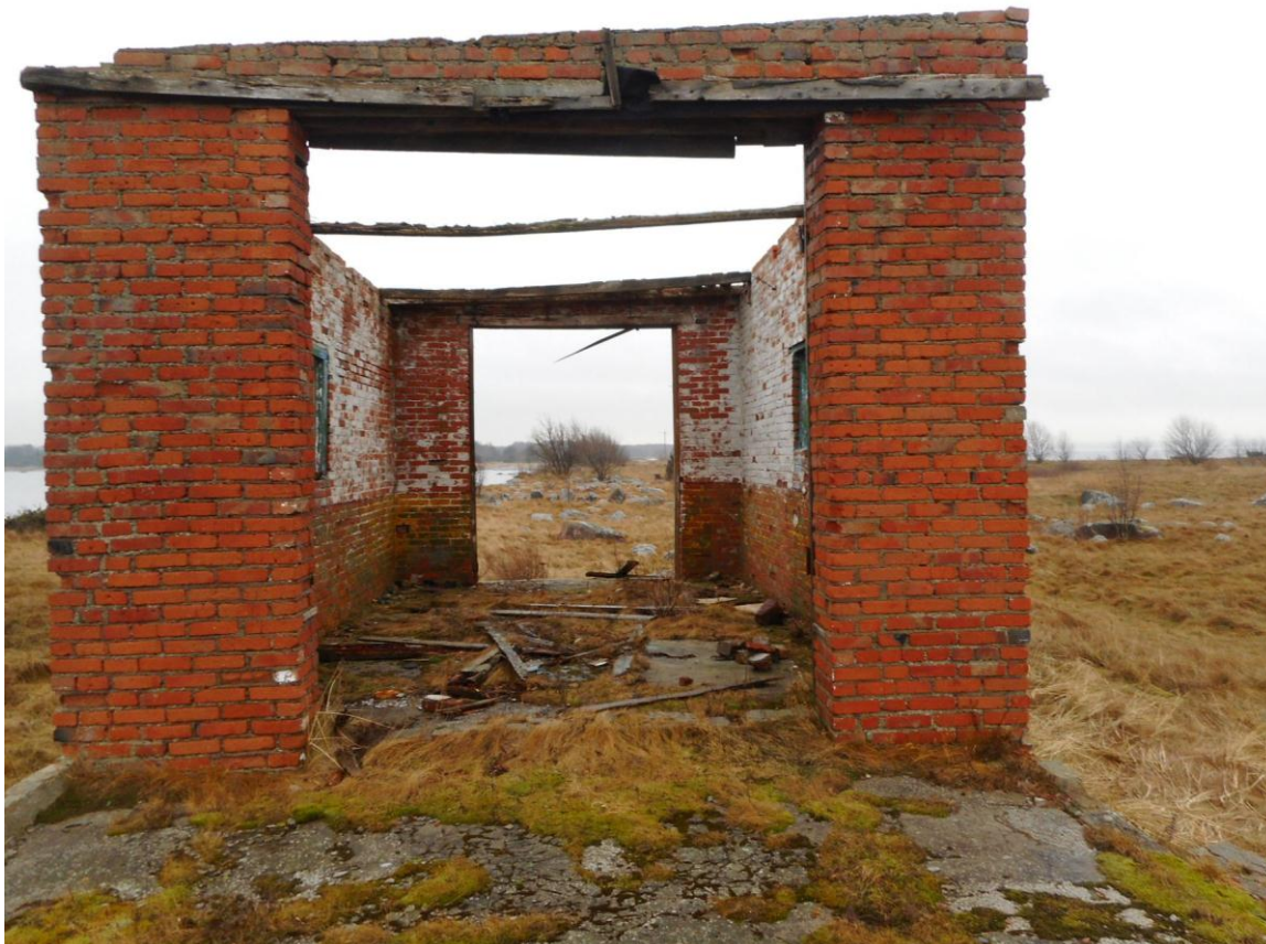
Foto 17. (333) Neeme tehnilise vaatluse post. Prožektorihoone [9] vaade põhjast. Väravasillused on puust, neid saaks veel kindlustada, enne kui need läbi mädanevad ja nende kantavad kivid alla sajavad. Foto Jüri Pärn 8.12.2016.
