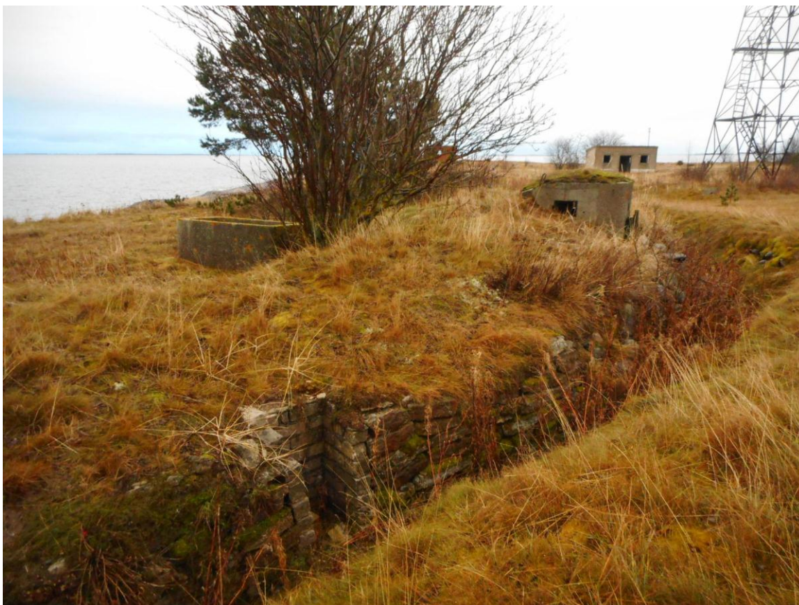
Foto 66. (880) Neeme tehnilise vaatluse post. Kaitsekraav [27], vaade läänest: doti SPS-2 [30] eemaldatud esik [31], dott SPS-2 [30]. Tagapool diislihoone [14] ja torn [26]. Foto Jüri Pärn 8.12.2016.
