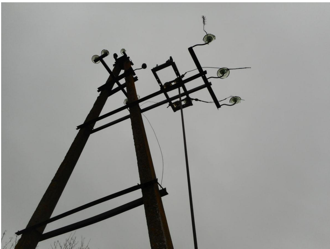
Foto 36. (439) Neeme tehnilise vaatluse post. Keskipingeliini A-kujuline ankrumast [16]. Foto Jüri Pärn 8.12.2016.
