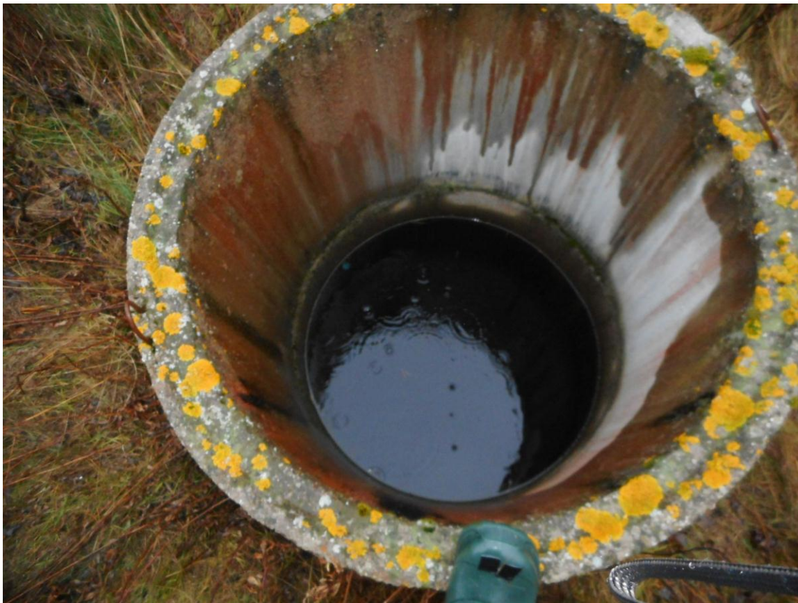
Foto 37. (615) Neeme tehnilise vaatluse post. Uus salvkaev [18]. Rajatud ajavahemikus 2002–2005. Foto Jüri Pärn 8.12.2016.
