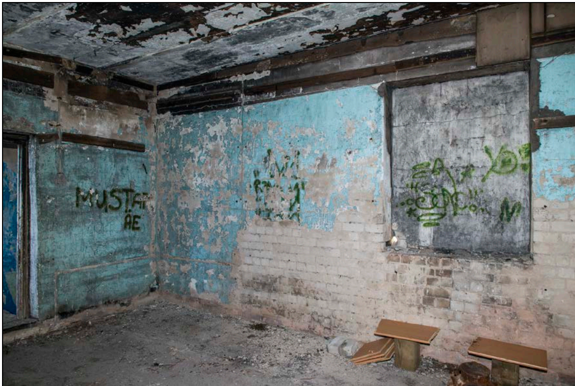
Foto 16 (060). Kaberneeme TVP komplekshoone [1]. Teise korruse ruumis on läänepoolne aken kinni müüritud.
