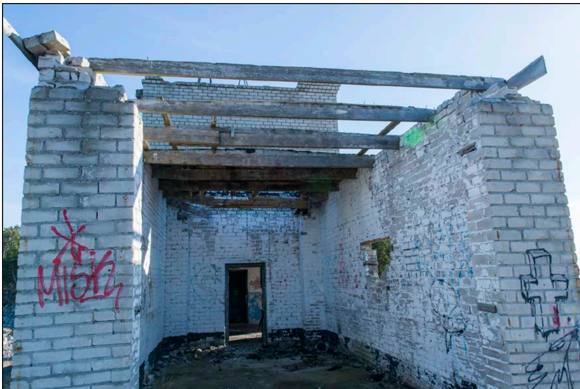
Foto 9 (042). Kaberneeme TVP komplekshoone [1]. Helgiheitja ruumi ukсед on kadunud, katus lagunenud.
