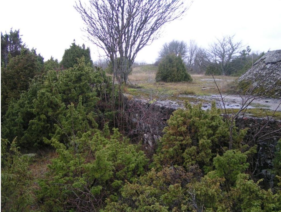
Foto nr 3 Sama, pinnasega katmata vundamendinurk,
