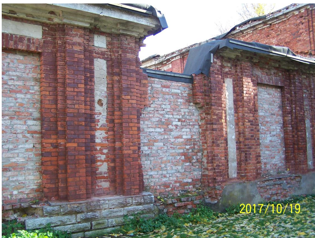
Foto 16 - Söögisali läänekülg, vaade loodest. Fotol näha osaliselt lagunenud müüriosa.
