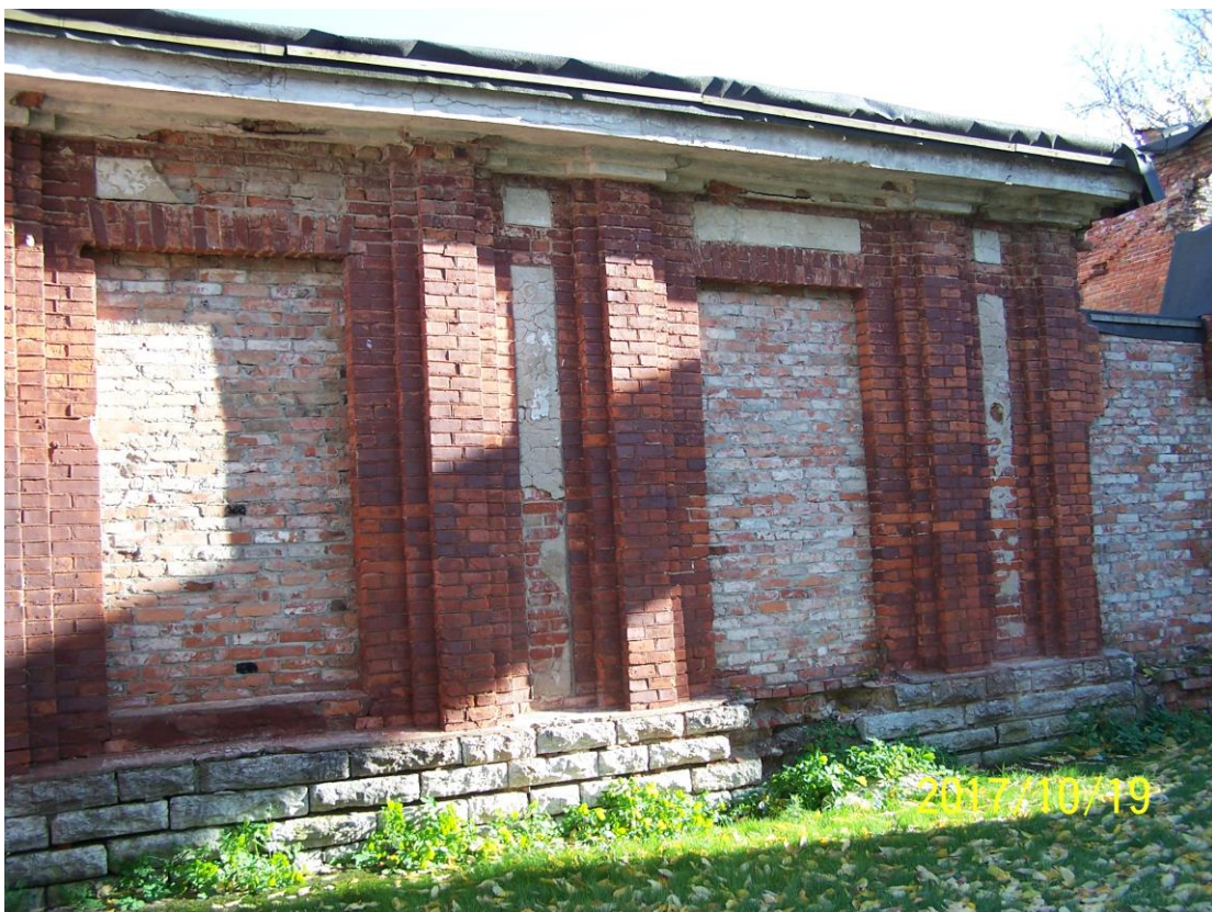
Foto 12 - Kasarmu söögisaali läänesein, vaade läänest. Sokliosjal näha osaliselt murenunud paeplaatide kiht.
