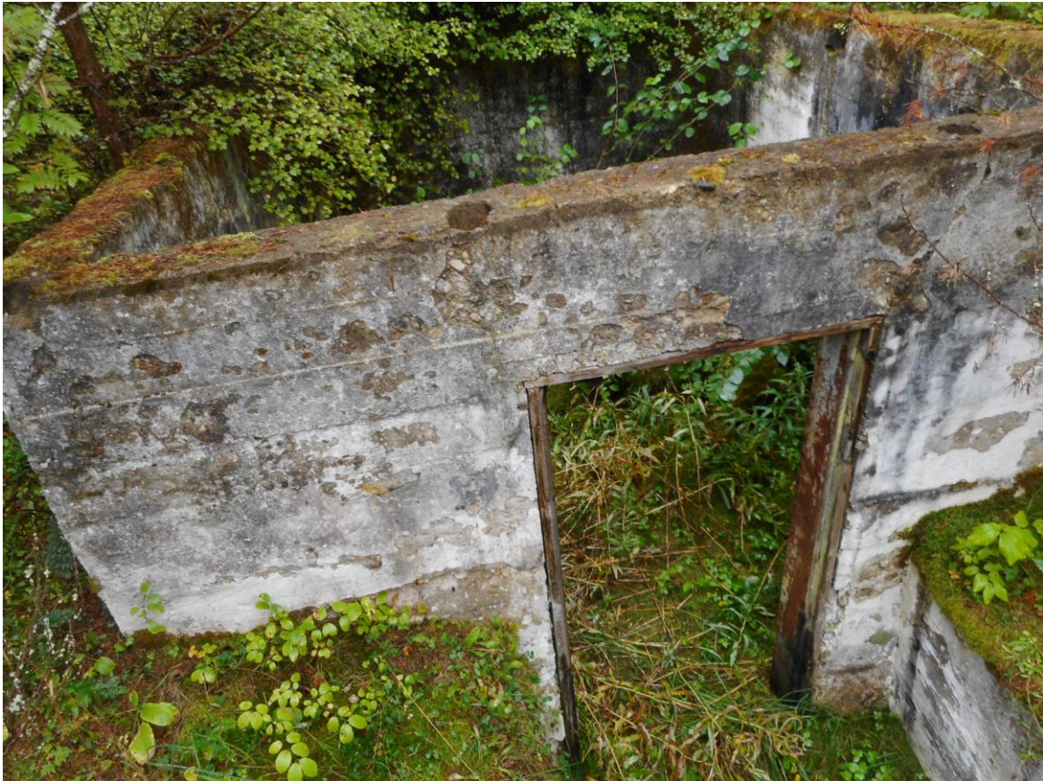
Foto 20. Kütusehoidla (joonised 3–4, hoone 6). Asub väljaspool piirdeaeda. Süvistatud maasse u 1 m sügavusele, sees 2 betoonist valatud vaadialust. Katus puudub, seinad tugevad, paksusega 20–30 cm.
