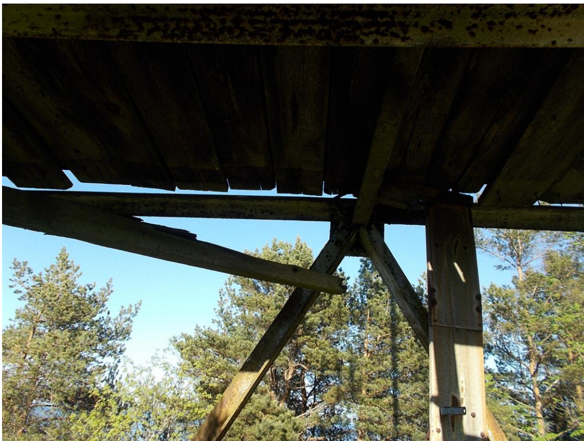
Foto 8. Torni alumise vaheplatvormi defektid lähivaates (9.05.2016).
