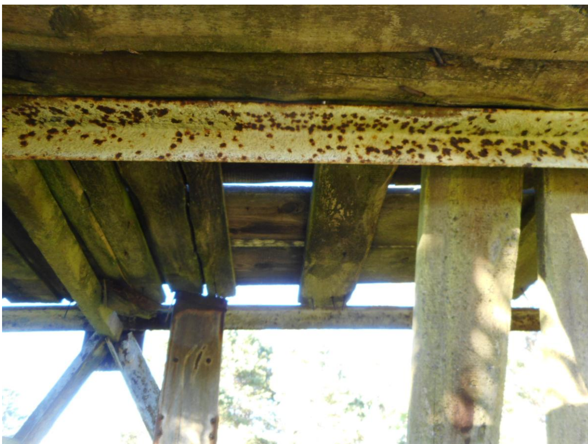
Foto 7. Tornis alumise vaheplatvormi defektid lähivaates (21.07.2017).
